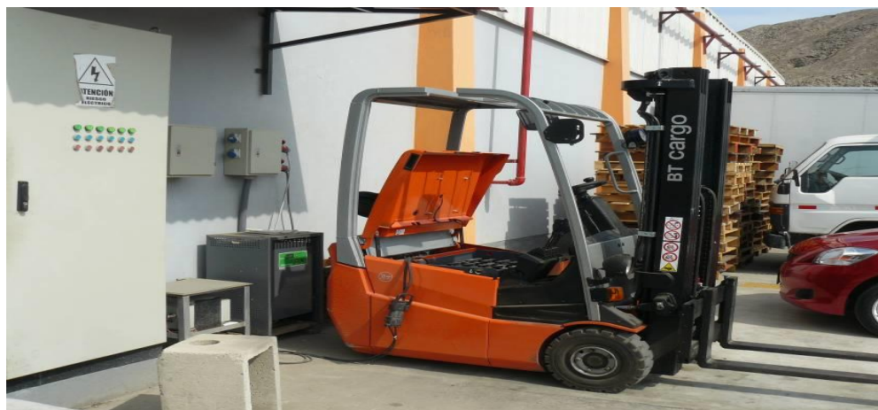
Figura 17. Cargadores de baterías
