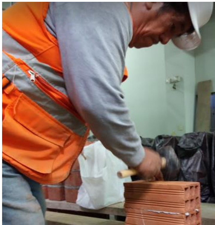
Figura 32: Asentamiento de unidades de albañilería con la masa Dun Dun para la elaboración de pila. Fuente: Material propio.
