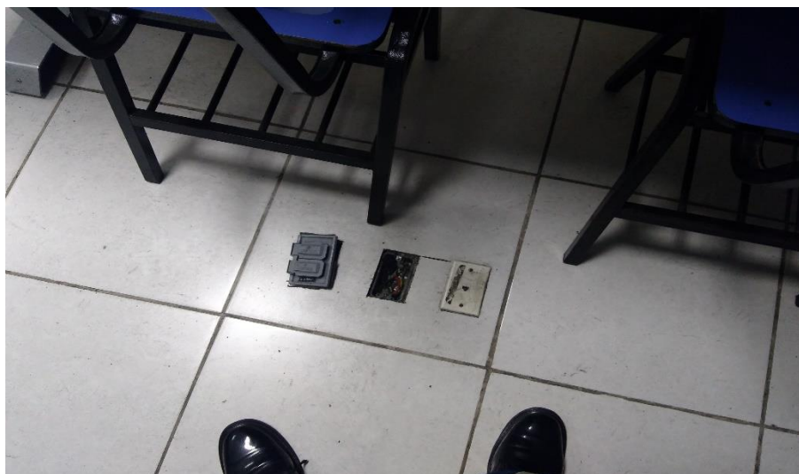
Figura 10 Condición subestandar Fuente: elaboración propia
