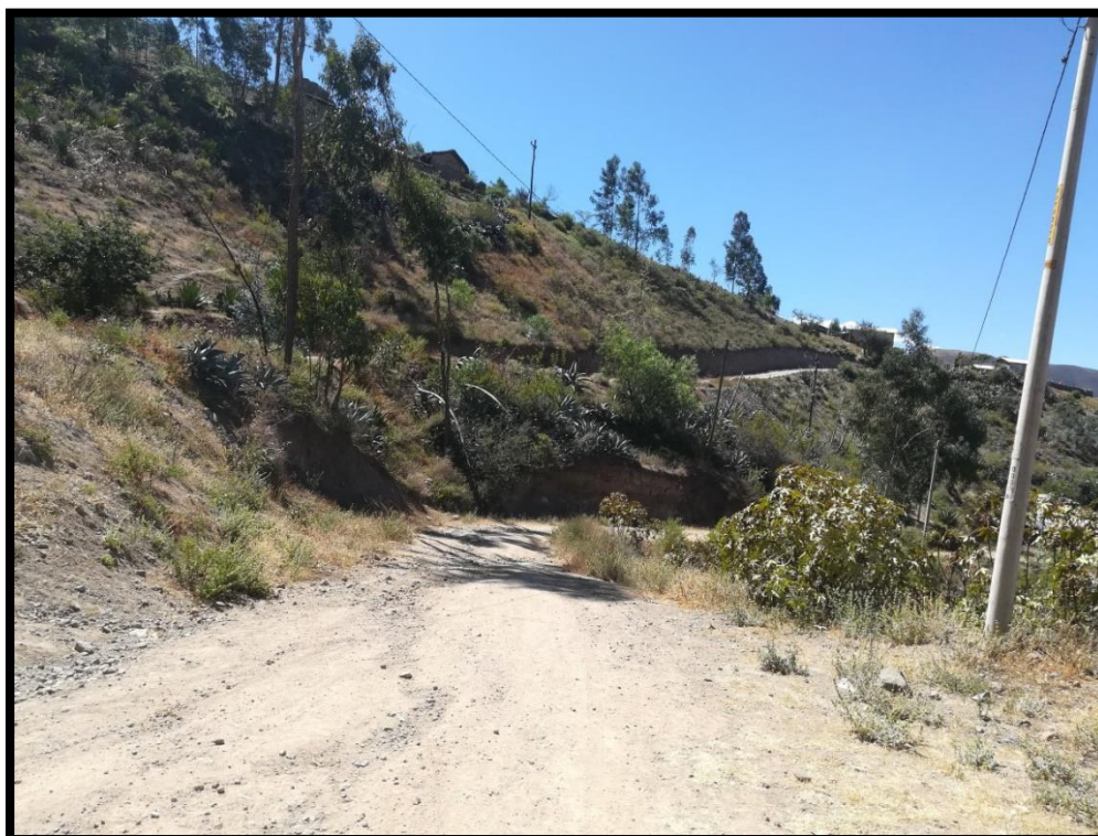
Anexo2: Estado actual de la carretera Kakamarca sin barandas de protección.
