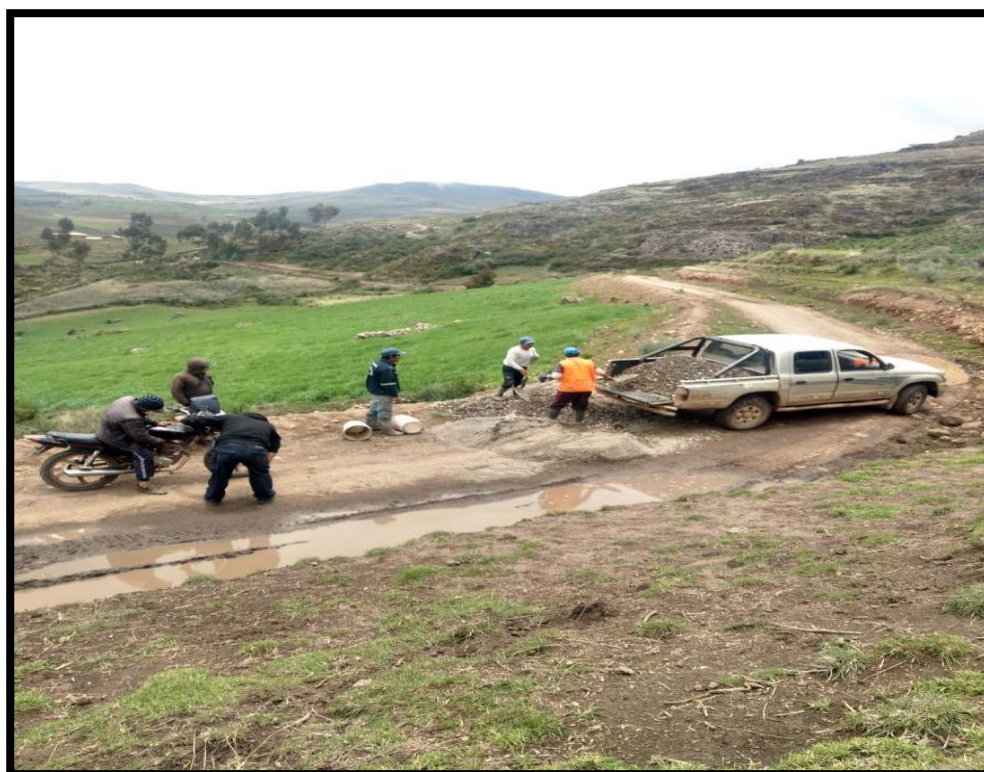
Anexo 1: Carretera con charcos de agua provenientes de las precipitaciones pluviales que se almacenan por falta de obras de arte.
