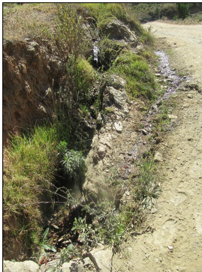
Ilustración N° 11: Se aprecia las cunetas de tierra en su totalidad de la carretera Bolognesi- Cabana
