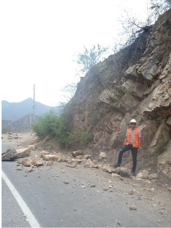
Anexo 221 Derrumbes en los taludes del sector La Pilca. Fuente: Propia
