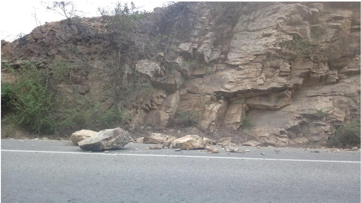
Anexo 220 Derrumbes en los taludes del sector La Pilca. Fuente: Propia
