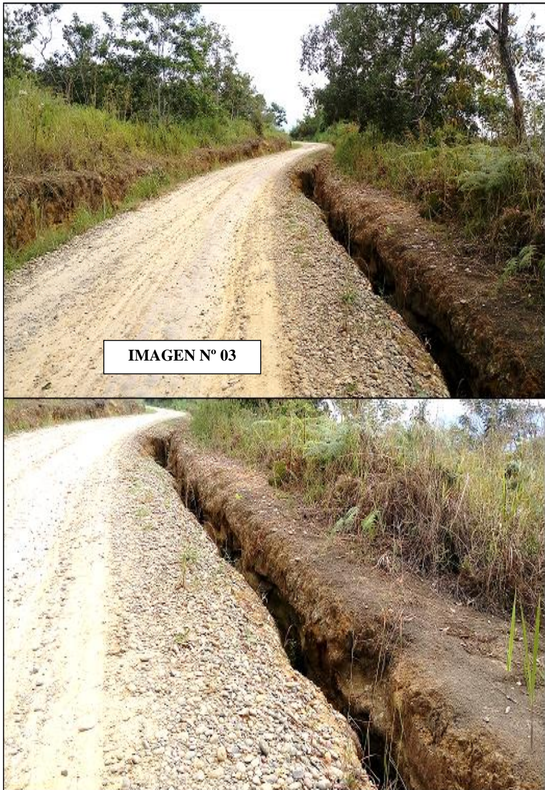
En la imagen N° 03 se observa la pérdida de la carpeta de rodadura existente en el Km 3+950 de la carretera Aucaloma, San Roque de Cumbaza, Provincia de Lamas.
