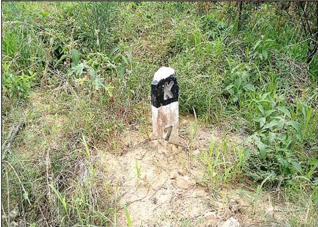
En la imagen N° 04 apreciamos el problema de hundimiento existente en zona crítica entre los Km 3+900 y Km 8+000 de la carretera Aucasoma, San Roque de Cumbaza, Provincia de Lamas.
