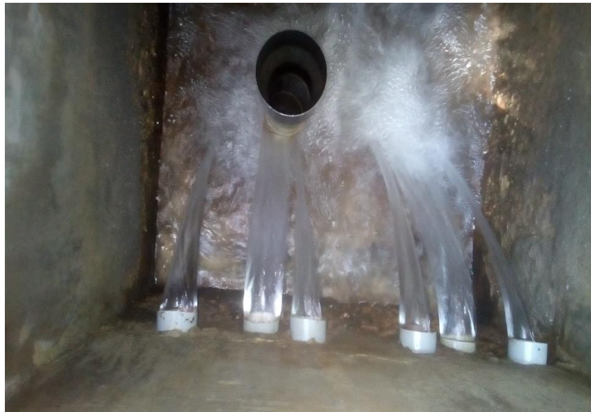
Imagen 1. Captación de agua del manantial Chorrobamba
