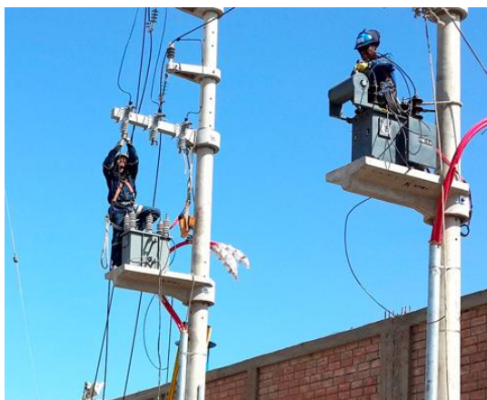
Imágen 9 Inspección de transformadores.
