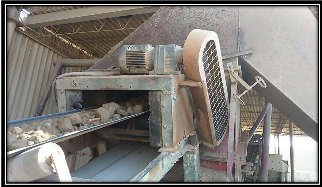
Se muestra el ingreso de la mezcla al molino mediante la faja transportadora N° 1.
