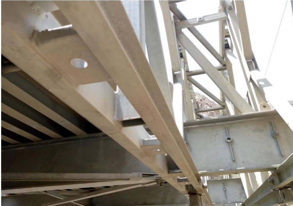
Imagen 5: En la siguiente imagen se percibe el emparrillado, en donde descansan los bloques colocados en la calzada del puente los cuales de igual forma presentan daños de fisura y golpes pero de forma superficial.
