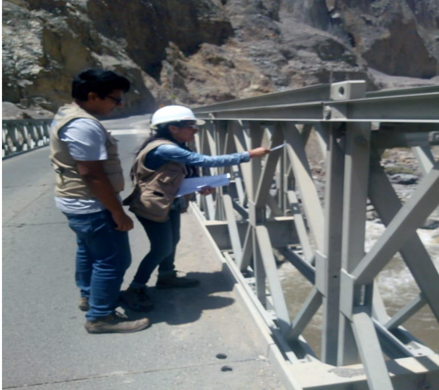
Imagen 3: En la siguiente imagen se percibe el panel Bailey el cual tiene daños superficiales de soldadura y golpes
