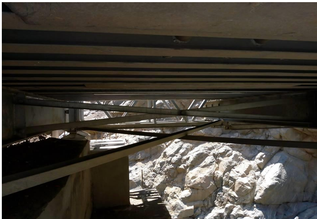
Imagen 6: En la siguiente imagen se percibe el bastidor de arriostramiento, debajo de la calzada del puente los cuales de igual forma presentan daños de fisura y golpes pero de forma superficial.
