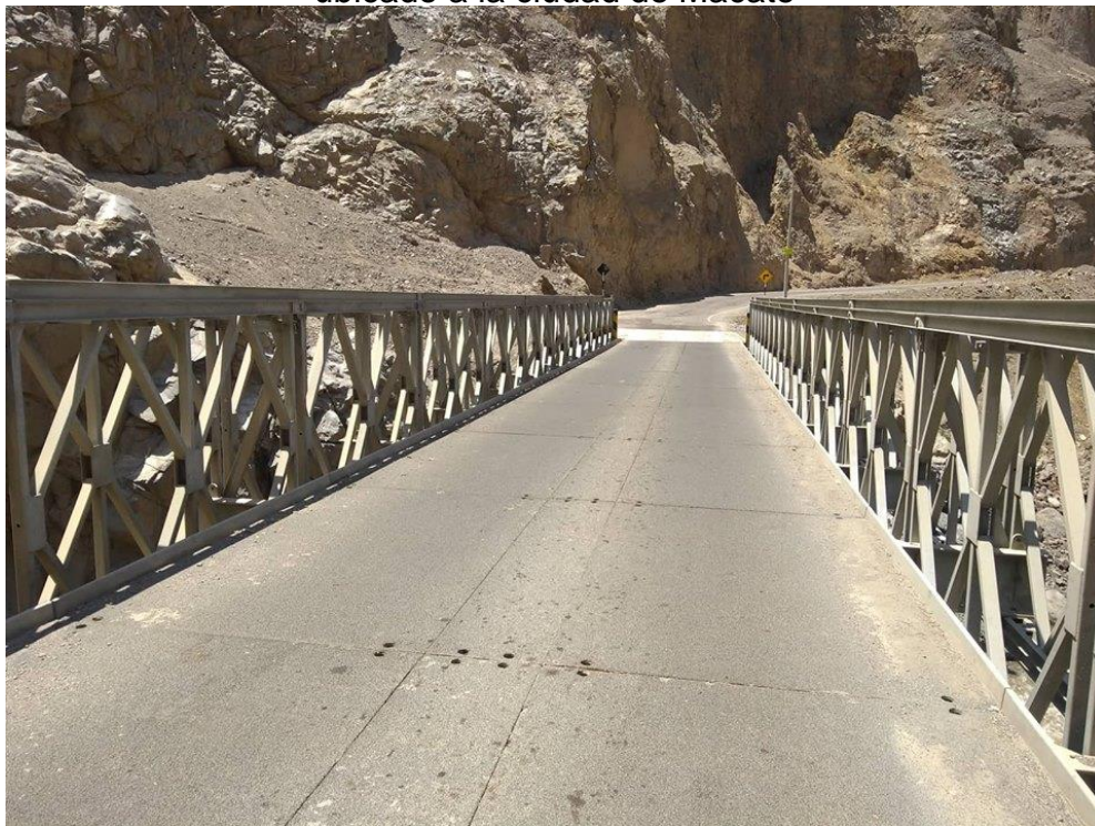
Imagen 2: En la siguiente imagen se percibe la estructura del puente, el cual se percibe pequeños daños superficiales, y faltantes como la pintura en el puente, señalización donde indica a los vehículos la llegada de un puente, y en las esquinas de la carretera del puente un pequeño desgaste.
