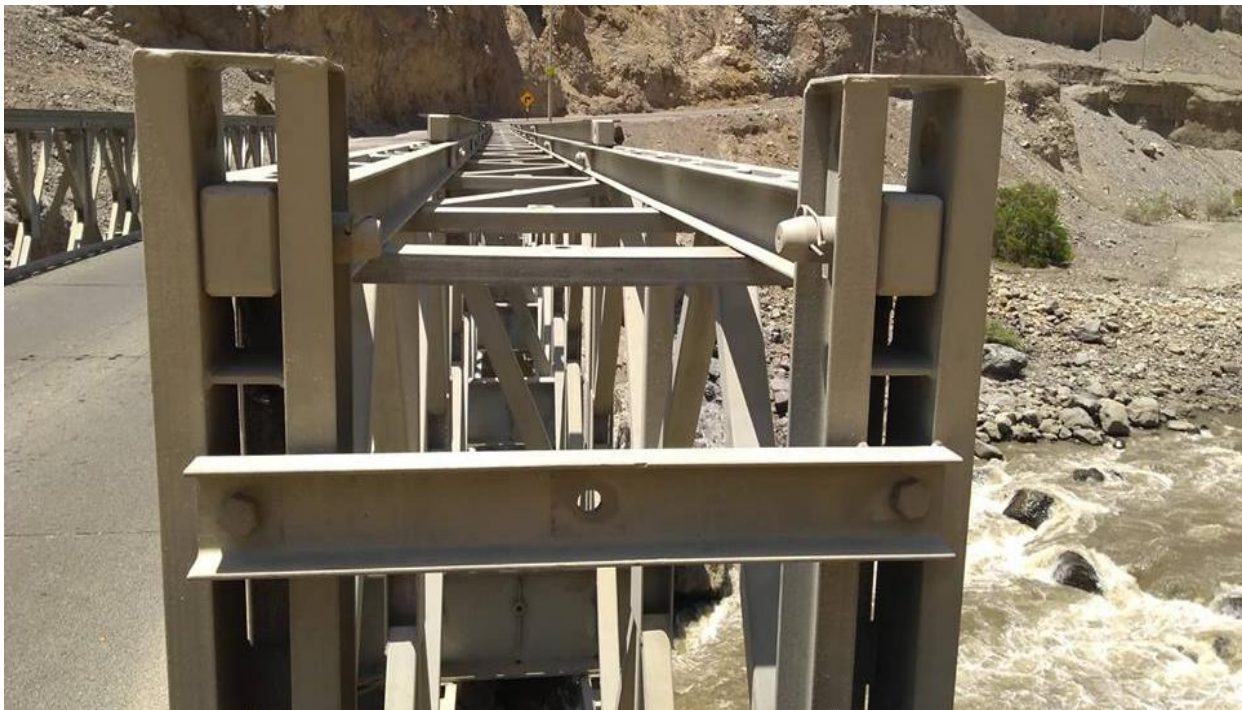
Imagen 4: En la siguiente imagen se percibe el travesero en las partes laterales y superior del puente los cuales presentan de igual forma daños tanto de soldadura y golpes pero de manera superficial.
