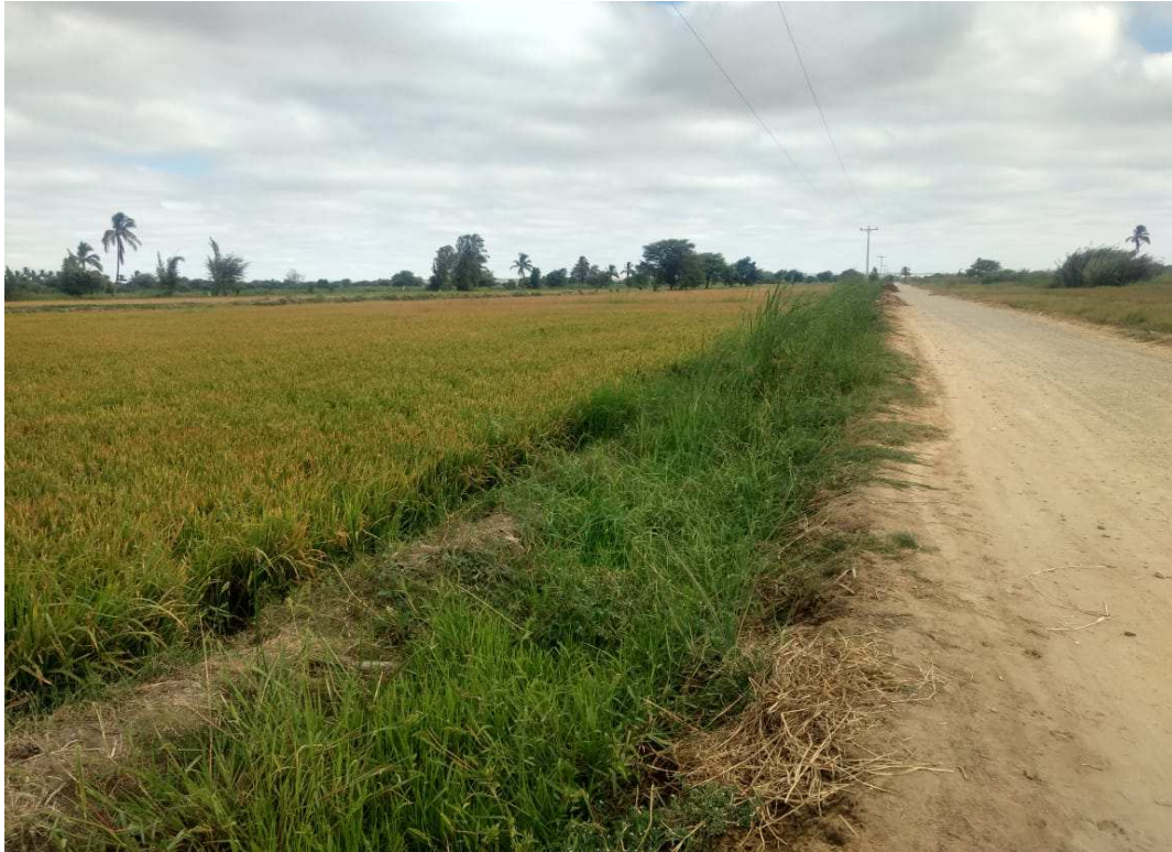
Figura 54. Presencia de humedad por la existencia de vegetación en la margen izquierdo del camino vecinal Buenos Aires, abscisa 0+300.
