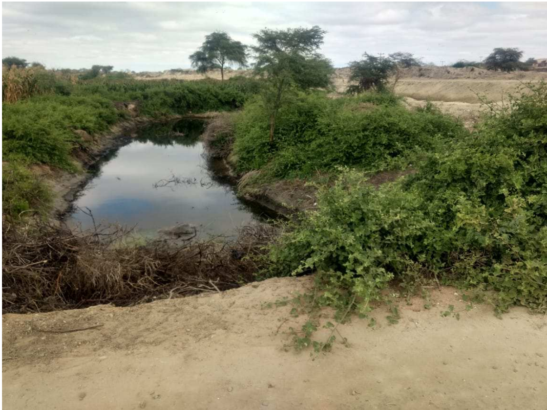
Figura 58. Presencia de una pequeña laguna de agua en el Km 1+000 del camino vecinal Buenos Aires.
