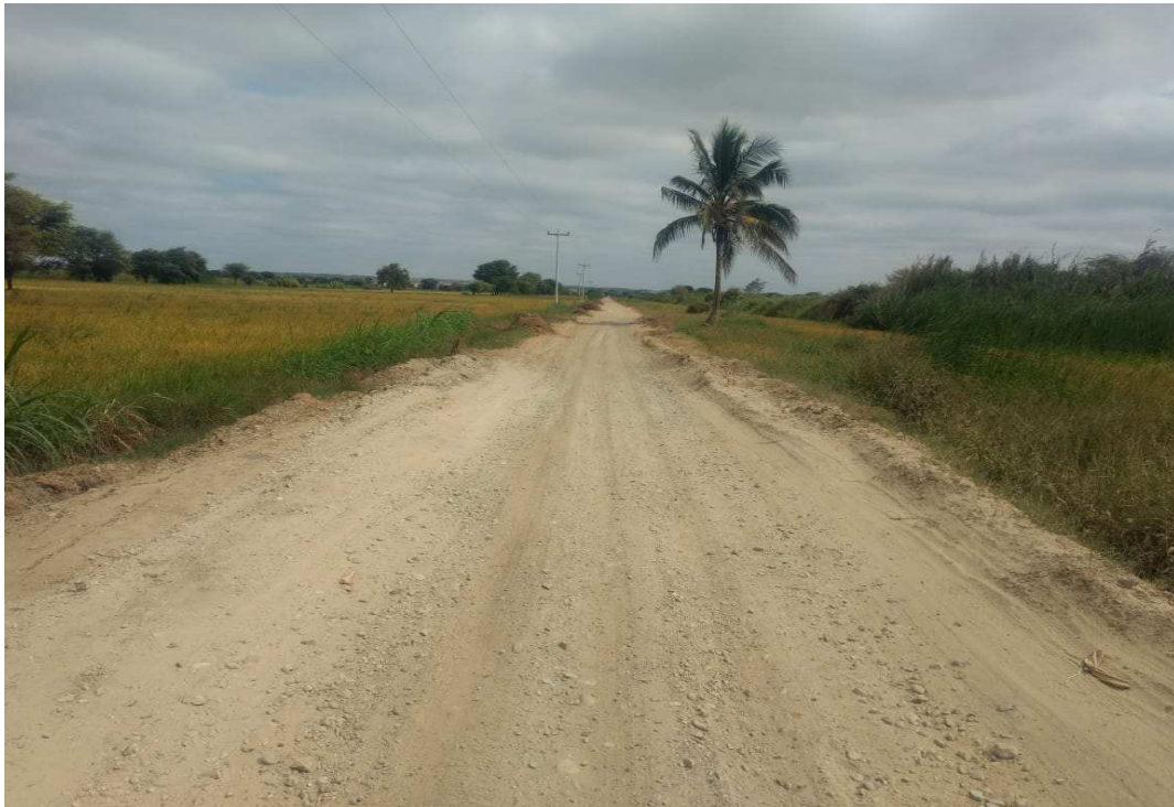
Figura 55. Presencia de fallas y/o daños en el camino vecinal por el exceso de agua en su estructura misma.
