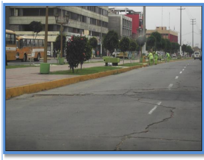
Figura 6: Se observa que la mala condición de las pistas dificulta el tránsito.
