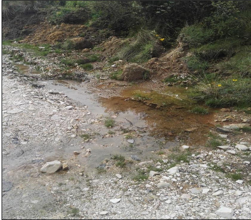
Agua estancada en la carretera por la falta de cunetas
