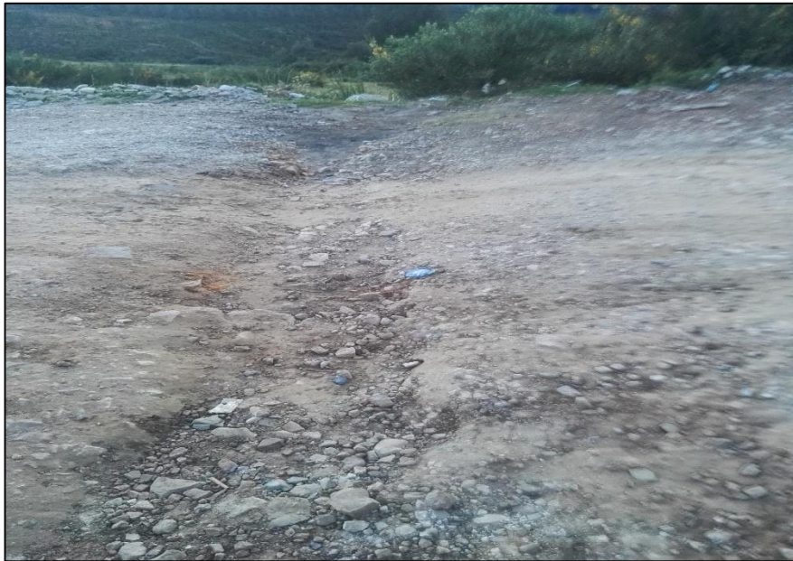
Desperfectos en la carretera por las intensas lluvias y la falta de obras de arte
