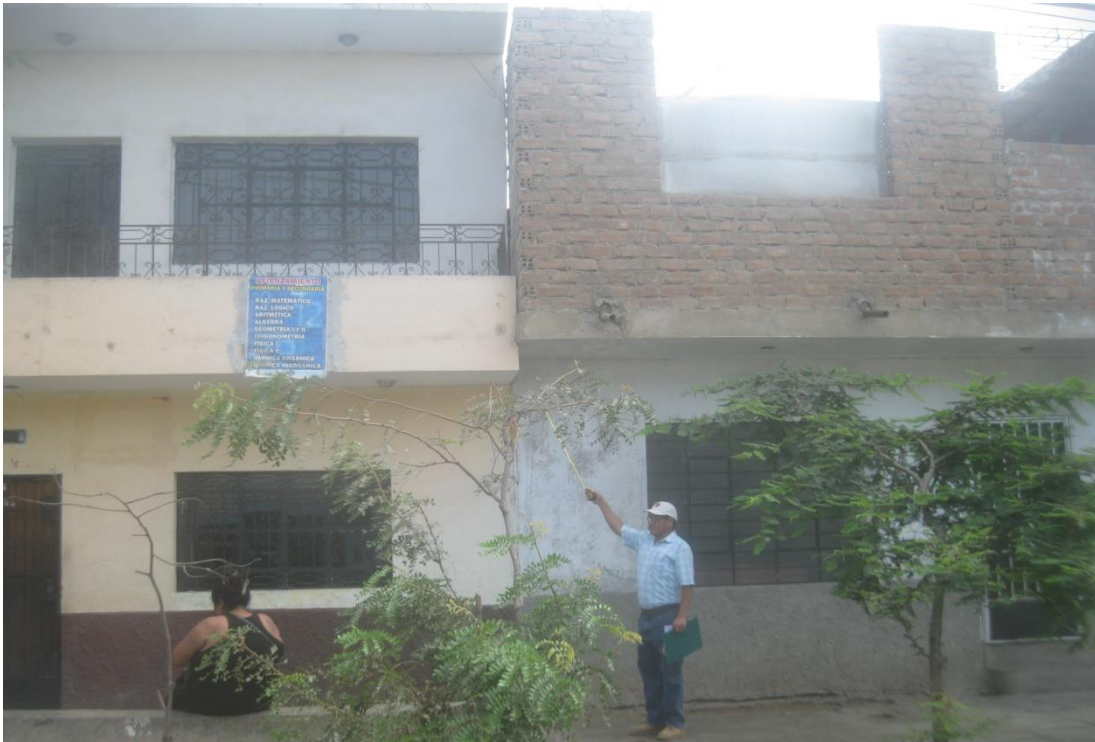
FOTO 19: VIVIENDAS SIN JUNTA DE DILATACIÓN
