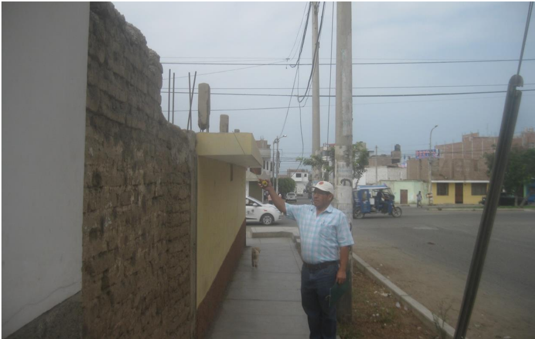
FOTO 13: FIERROS EXPUESTO EN COLUMNAS Y TECHO BAJO
