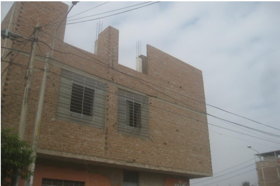
FOTO 12: MUROS CON LADRILLO PANDERETA EN VOLADIZO SIN ARRIOSTRE
