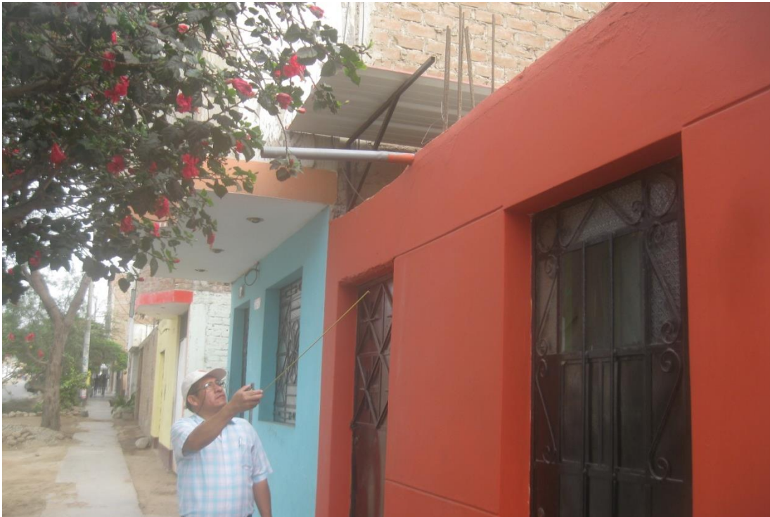
FOTO 09: VIVIENDA DE UN PISO CON FIERROS DE COLUMNA EXPUESTO
