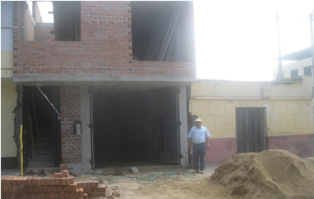
FOTO 23: DESPERDICIO DE MATERIALES EN OBRA
