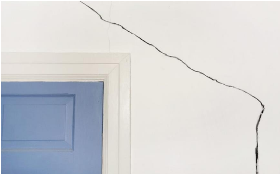
FOTO 26: FISURA EN MUROS DE VIVIENDA
