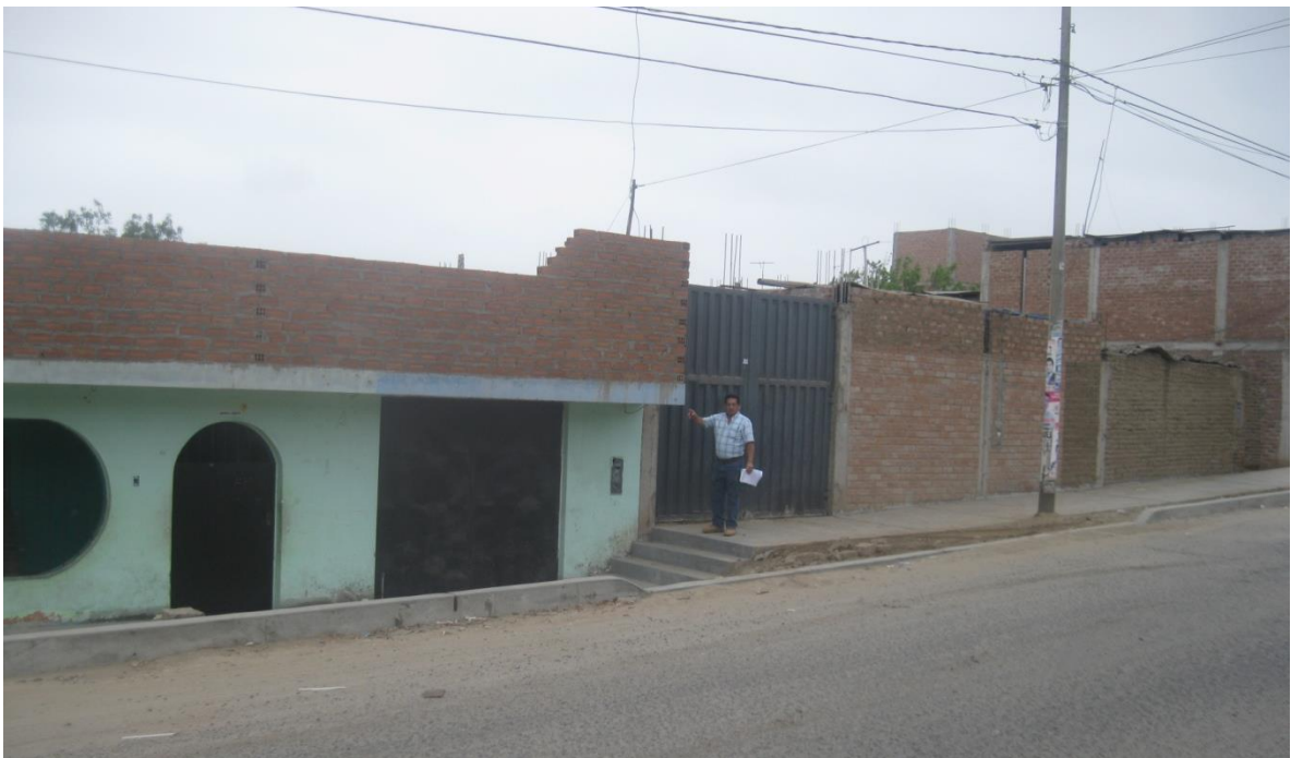
FOTO 02: VIVIENDA CON DEFECTO EN ALTURA DE MURO- DESNIVEL DE VEREDA
