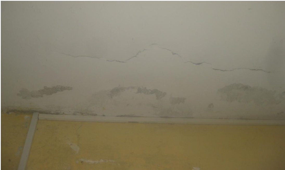
FOTO 27: FISURA EN VIGUETAS - CIELOS RASOS DE VIVIENDA
