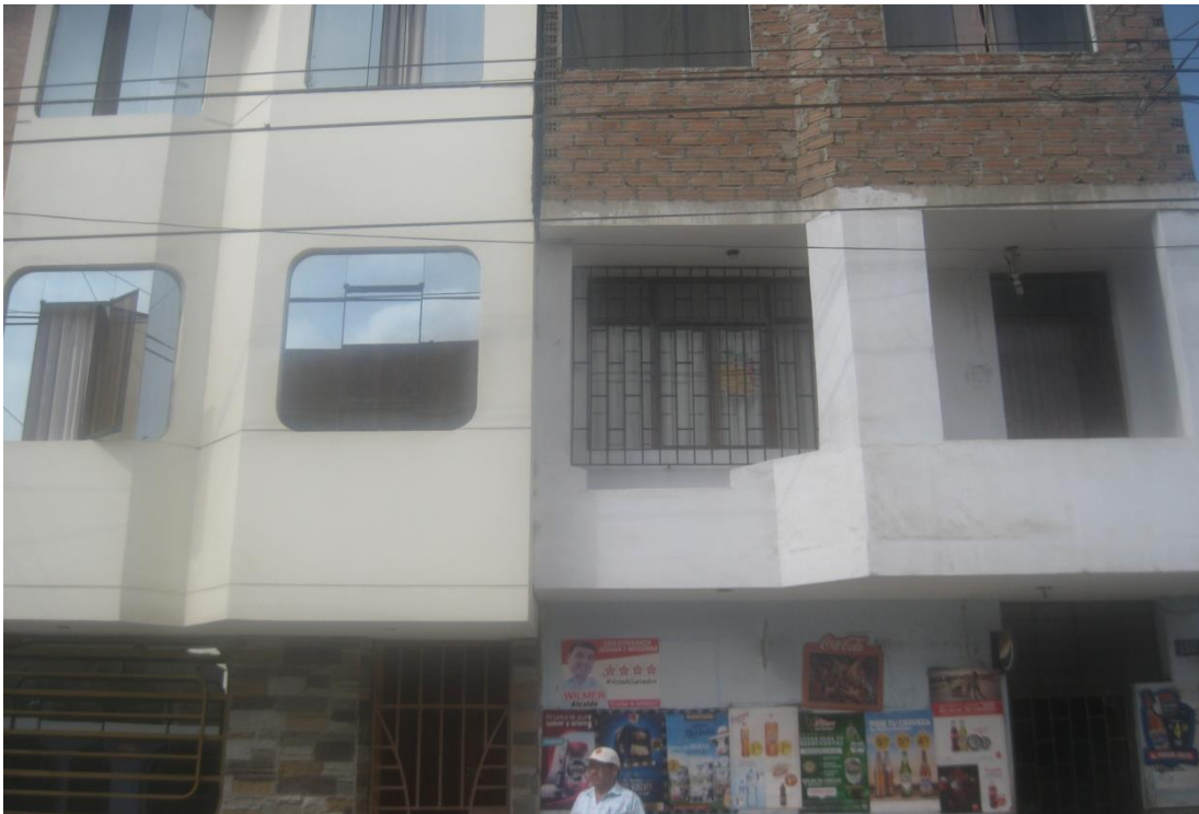
FOTO 24: VIVIENDAS DE TRES PISOS SIN JUNTA DE DILATACIÓN SISMICA
