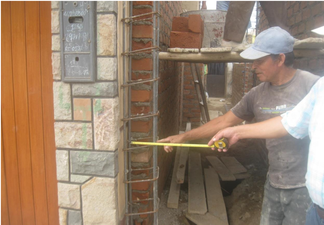
FOTO 15: VIVIENDAS SIN JUNTAS DE DILATACION
