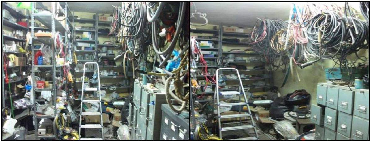
Figura 5: Situación encontrada en el almacén antes de la mejora.
