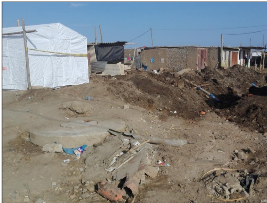
Figura 53: Red de Agua y Desagüe en mal estado
