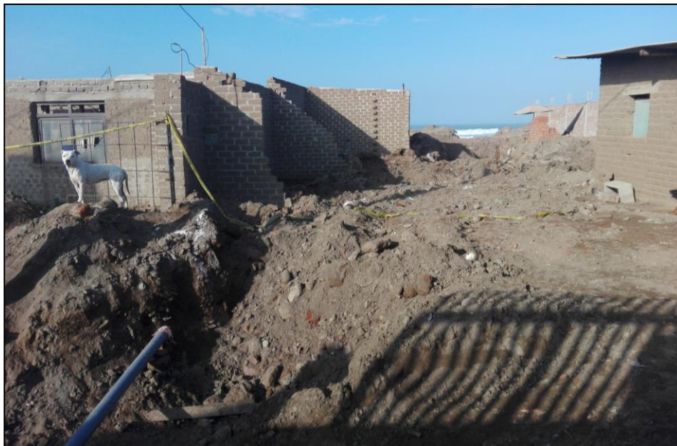
Figura 51: Vivienda con material de Ladrillo sin quemar, servicio de Agua colapsados y calle no definida
