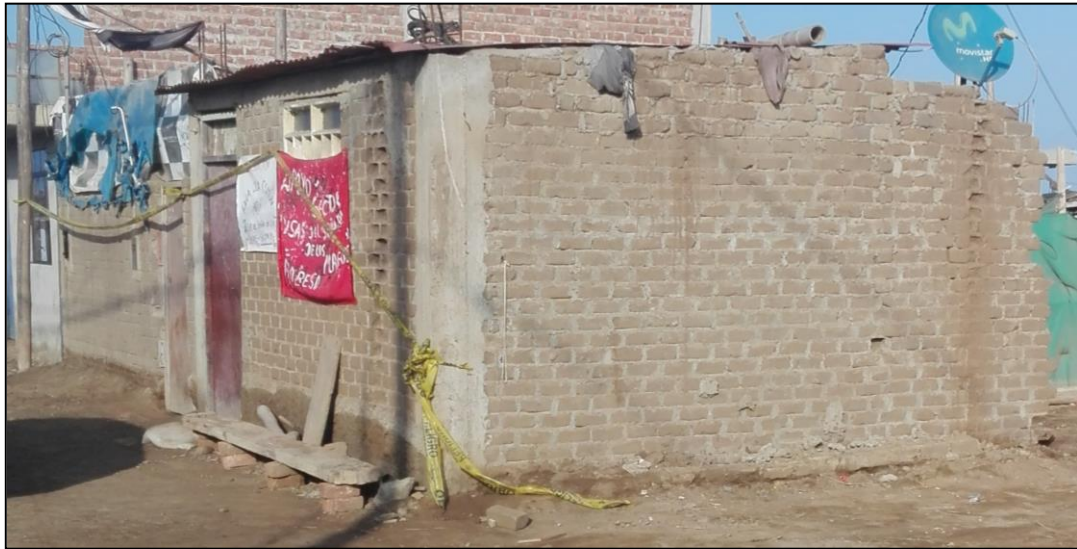
Figura 55: Vivienda con material de Ladrillo sin quemar, no cuenta con áreas sin definir, cobertura no apropiada
