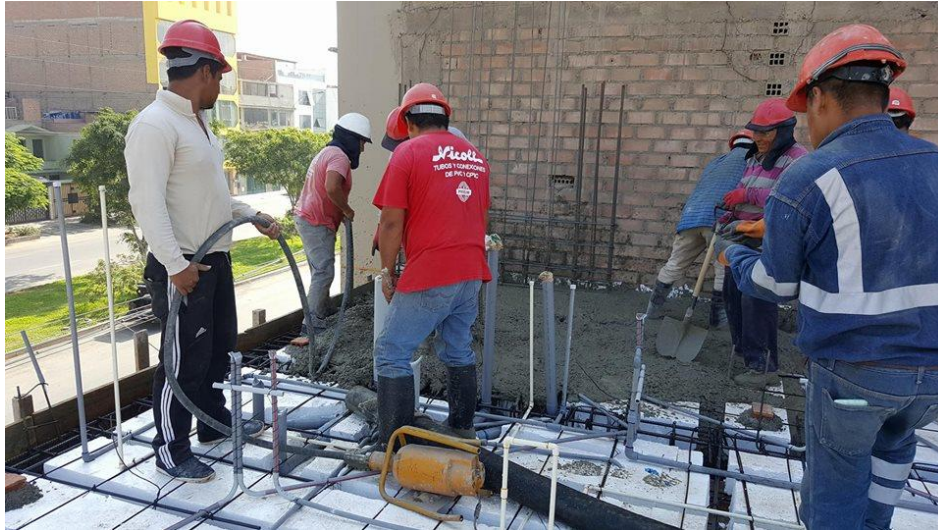
Figura 3.6 Vaceado de losa aligerada de e = 0.20 m. del primer nivel empleando vibradora.
