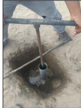
POSTEO DE TERRENO PARA FACILITAR EL INGRESO DE TUBERÍA Y EVITAR EL DESMORONAMIENTO DE ARENA SATURADA
