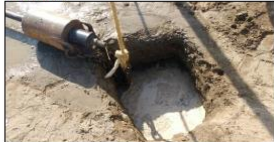
PRESENCIA DE NIVEL FREÁTICO EN CALICATA AL FINALIZAR ENSAYO
