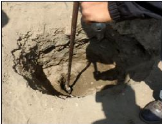
POSTEO INICIAL EN CALICATA PARA DAR INICIO AL HINCADO EN EL SONDEO SPT N° 03
