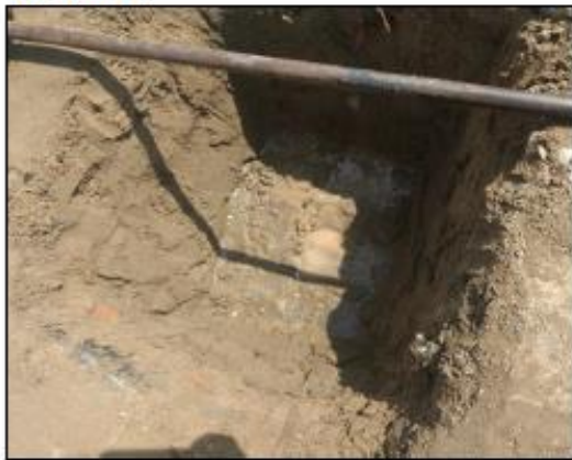
PRESENCIA DE NIVEL FREÁTICO A POCA PROFUNDIDAD DE CALICATA
