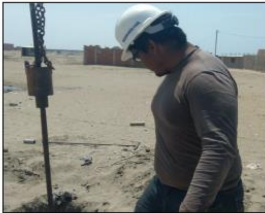
VERIFICACIÓN DE CALICATA Y POSICIÓN DE CAÑAS PARA DAR INICIO AL SONDEO SPT N° 05
