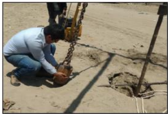
INSTALACIÓN DE CAÑAS Y COLOCACIÓN DE YUNQUE PARA DAR INICIO AL SONDEO SPT N° 03
