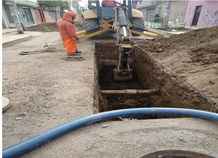
Figura 19 tubería de red de agua Fuente propia
