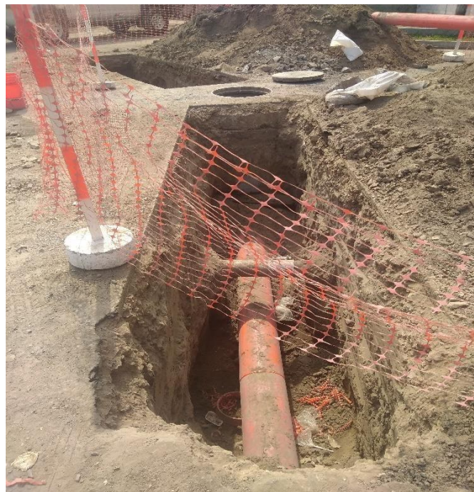
Figura 20 Tubería de red de fibra óptica generando interferencia
