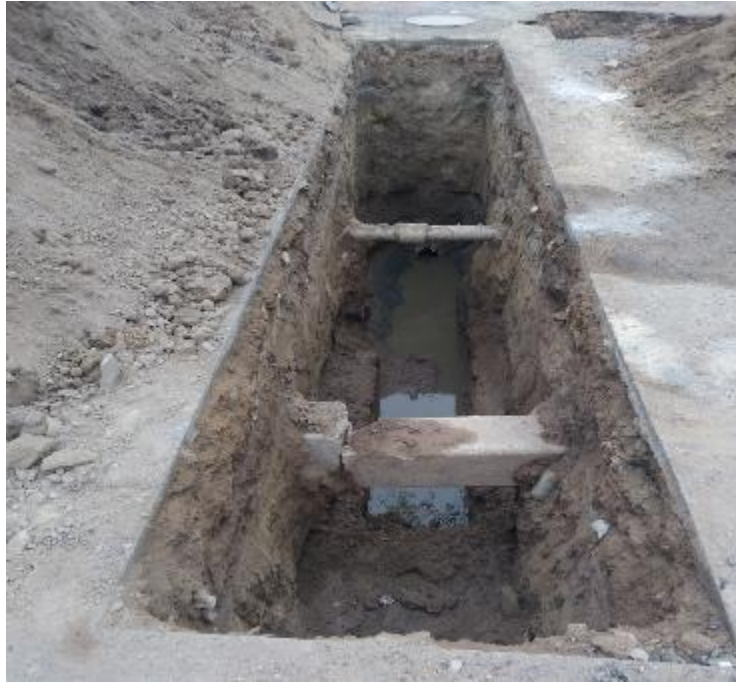
Figura 23 Banco ducto eléctrico generando interferencia Fuente propia
