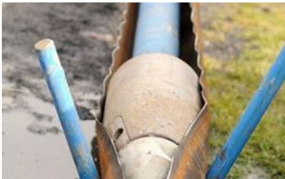
Figura 4. Demostración fragmentación (bursting) tubería acero. Fuente: construtec.com
