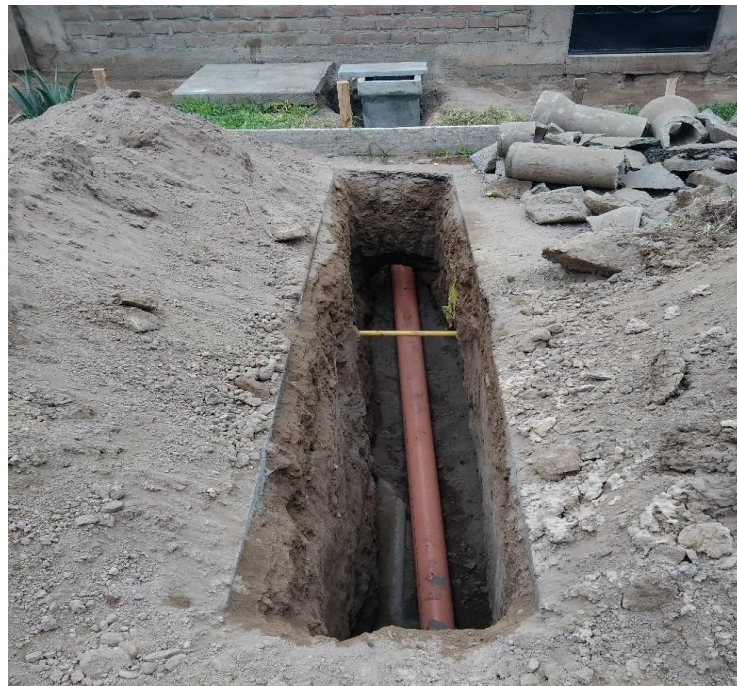
Figura 1 Fuente propia tubería de alcantarillado generando desperdicios
