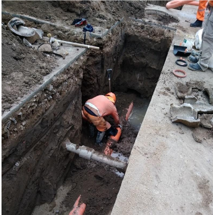
Figura 21 tubería de alcantarillado generando interferenci Fuente propia
