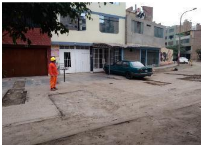
Figura 24 pistas dañadas Fuente propia
