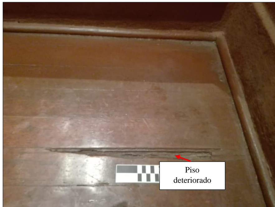
Figura 9: Vista del piso deteriorado en el segundo ambiente de la Sala
