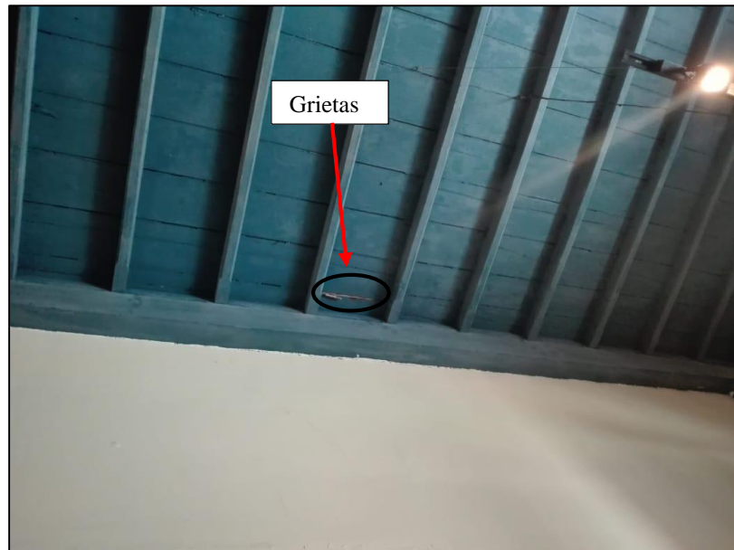
Figura 27: Vista del techo deteriorado (pequeñas grietas)
