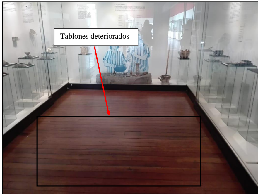
Figura 18: Vista del piso, al caminar se evidencia que las tablas no se encuentran bien adheridas al contrapiso
