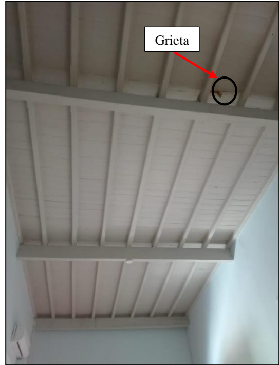
Figura 17: Vista del techo deteriorado
