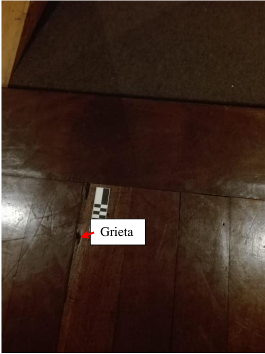
Figura 34: Vista del piso deteriorado.
