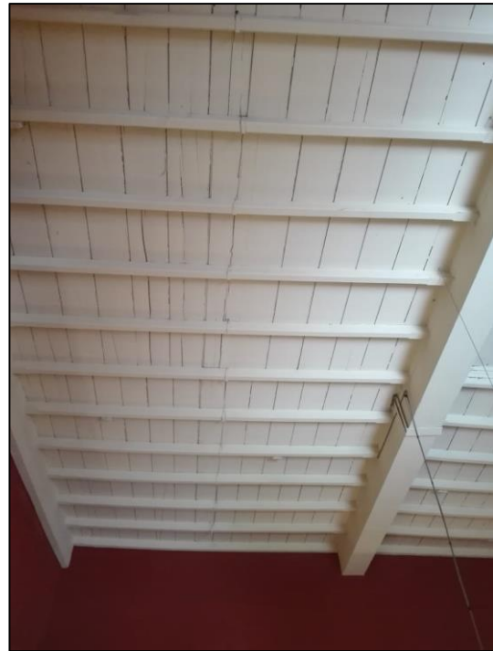
Figura 29: Vista de techo deteriorado, presenta grietas
