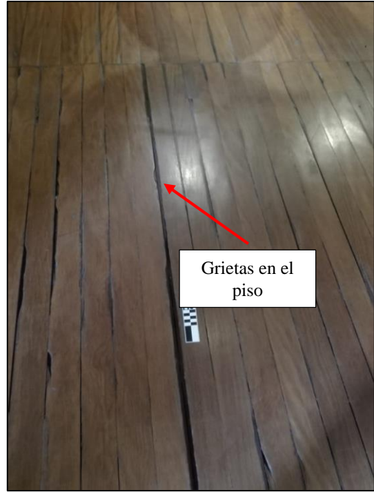
Figura 26: Vista del piso deteriorado
