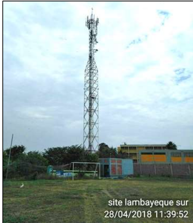
Figura 11: Vista Torre Autosoportada cuadrada 40m.
