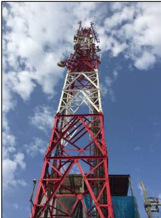
Figura 5: Vista Torre Autosostenida (Pescadores)
