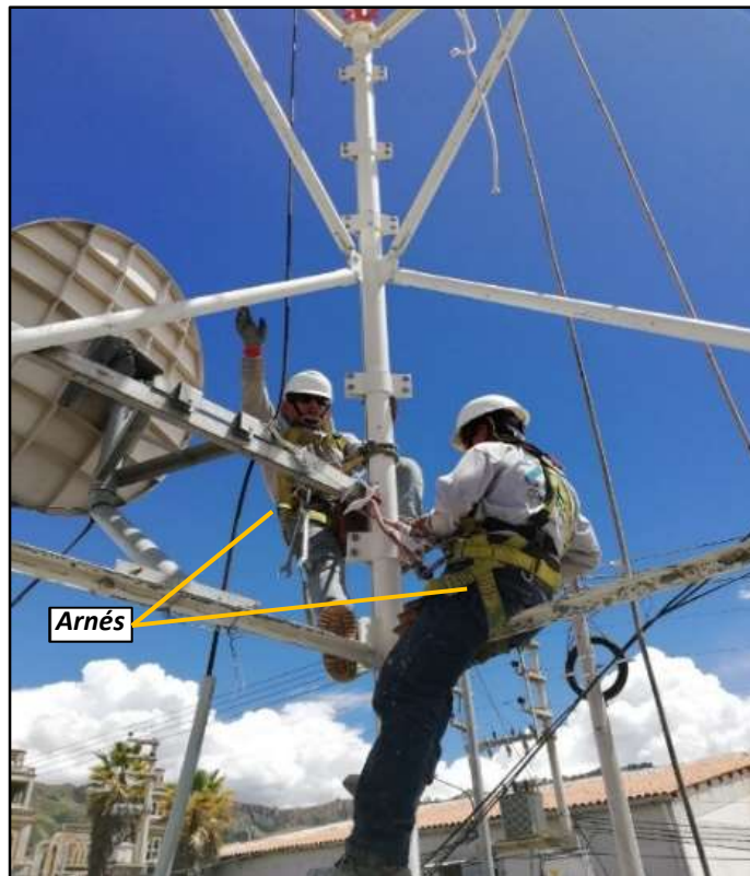
Figura 7: Sistema de seguridad para ascender y descender en una torre.
