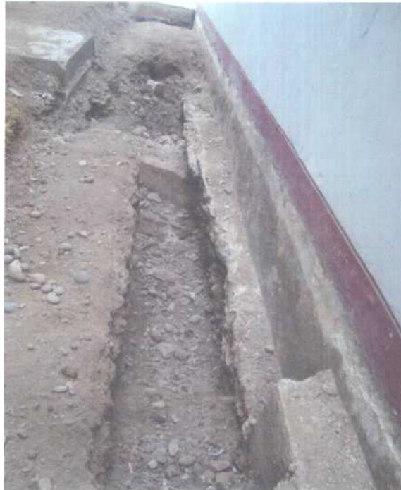
Figura 12. Cimentación MR-1 insuficiente para cimentar columnas C-5. Fuente: Elaboración propia
