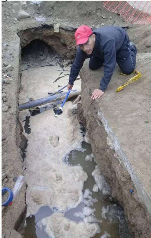
Imagen 1 Registro Fotográfico Izquierda situación actual fallas en las estructuras de los buzones
