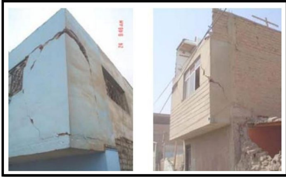
Figura N° 48. Fachadas no confinadas producto del sismo.
