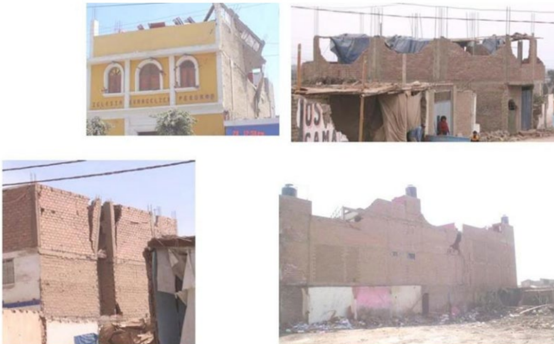
Figura N° 45. Falla de muros por falta de arriostre superior
