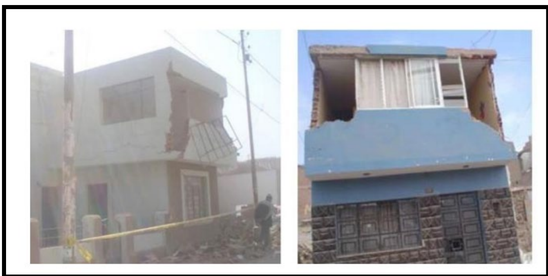
Figura N° 47. Fachadas no confinadas producto del sismo
