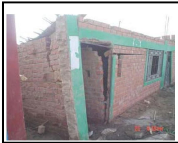
Figura N° 49. Vivienda sin confinamiento de vigas ni columnas, se produce la desintegración de muros y colapso total.
