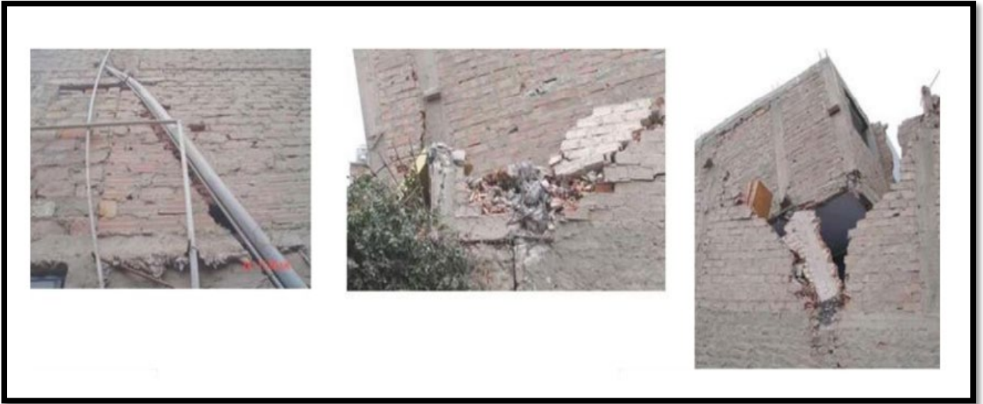
Figura N° 44. Muro de ladrillo fallado
