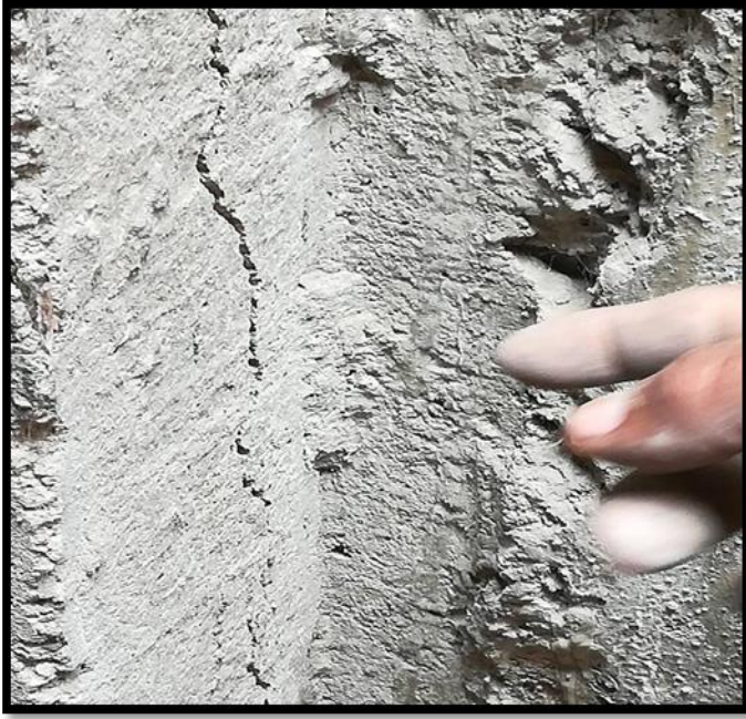
. Anexo 21: corrosión grave de acero.
