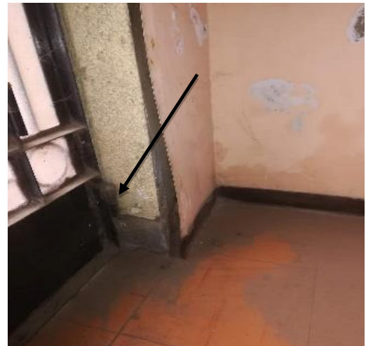
Fisuras y desprendimiento del material.
