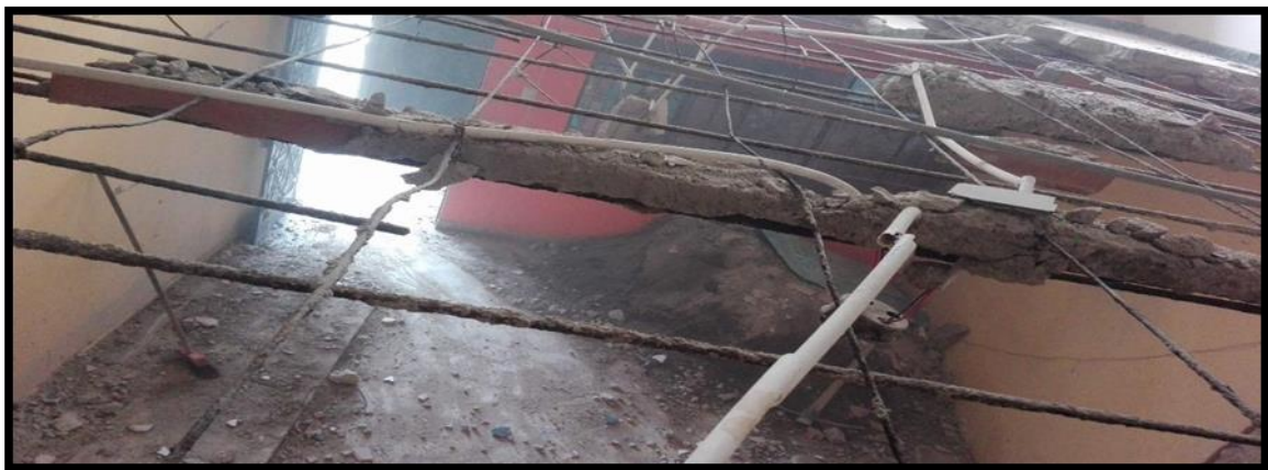
Figura 3. Corrosión en el concreto armado (losa aligerada).
