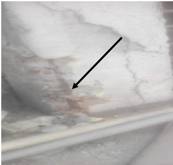
Corrosión con gran magnitud en la columna de entrada de dicha vivienda afectada.
