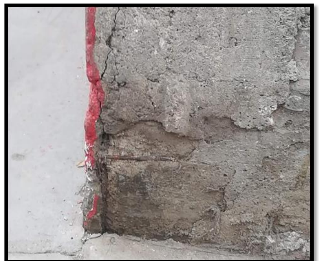
Anexo 20: corrosión grave
