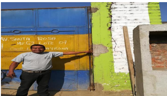
Anexo25: corrosión en columnas
