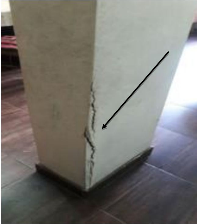
Columna central con Fisuras de 5mm
