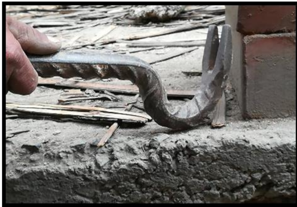
Prueba de cajoneo para ver si el elemento ha llegado a corroerse
