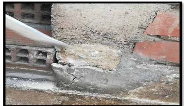
Anexo 14: desprendimiento del ma-
