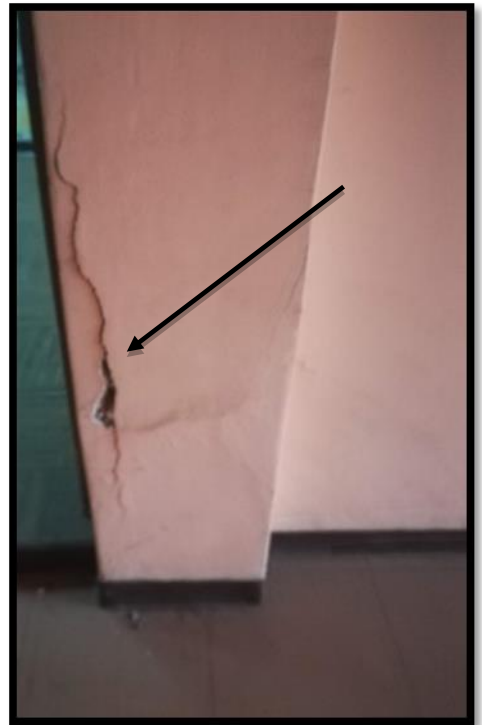
Fisuras y con desprendimiento del material(sala)
