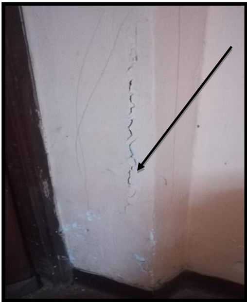
Fisuras de espesor de 3.5mm de inicio a fin en la columna del cuarto principal.
