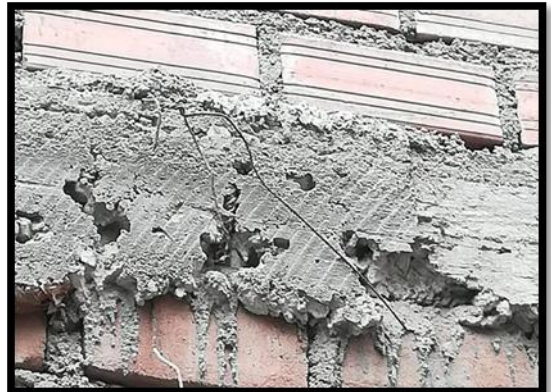
Cangrejeras en gran extensión en las vigas.
