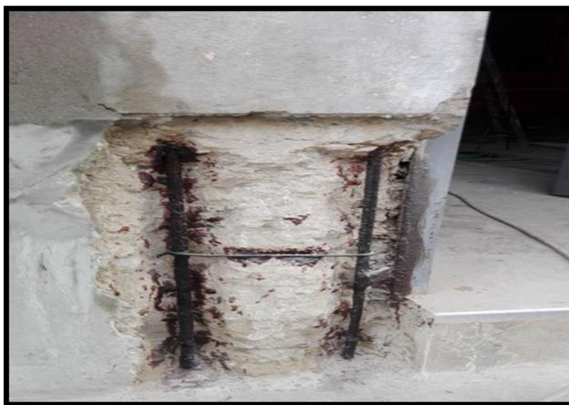
Figura 1. Corrosión en el concreto armado (columna).
