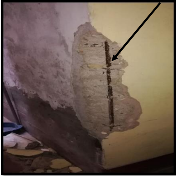
Corrosión en el acero de refuerzo y estribos.
