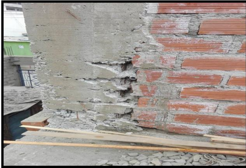
Figura 2. Elemento estructural defectuoso con cangrejera.
