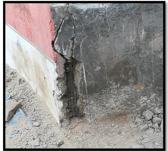
Anexo 16: acero corroído.
