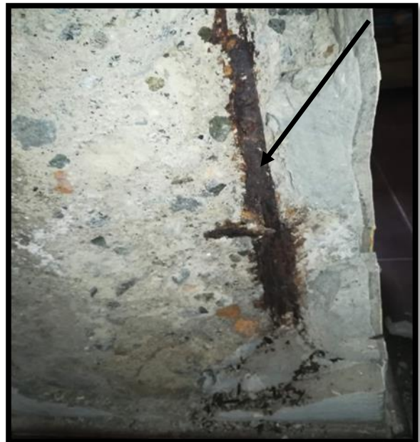
Corrosión en el acero de refuerzo, además se observa que la corrosión es de gran magnitud.
