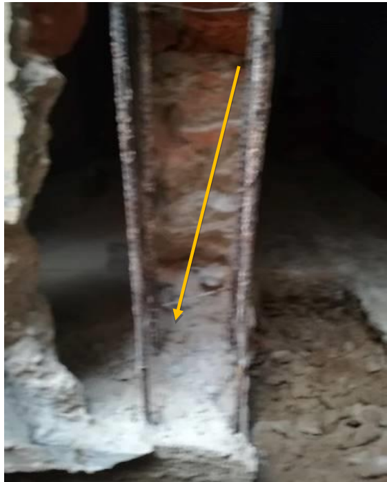
Corrosión en todo el tramo
