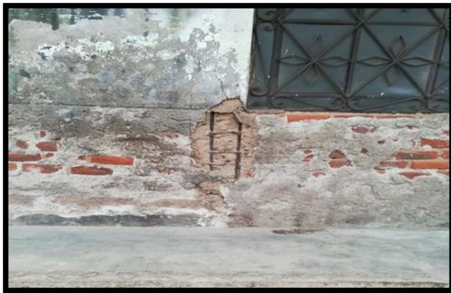
Anexo 17: corrosión grave de acero.
