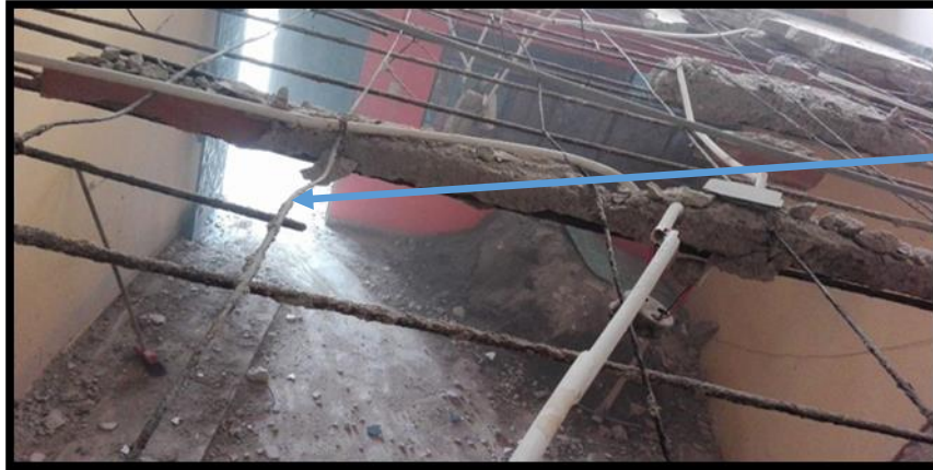
Corrosión en las viguetas en todas las direcciones.
