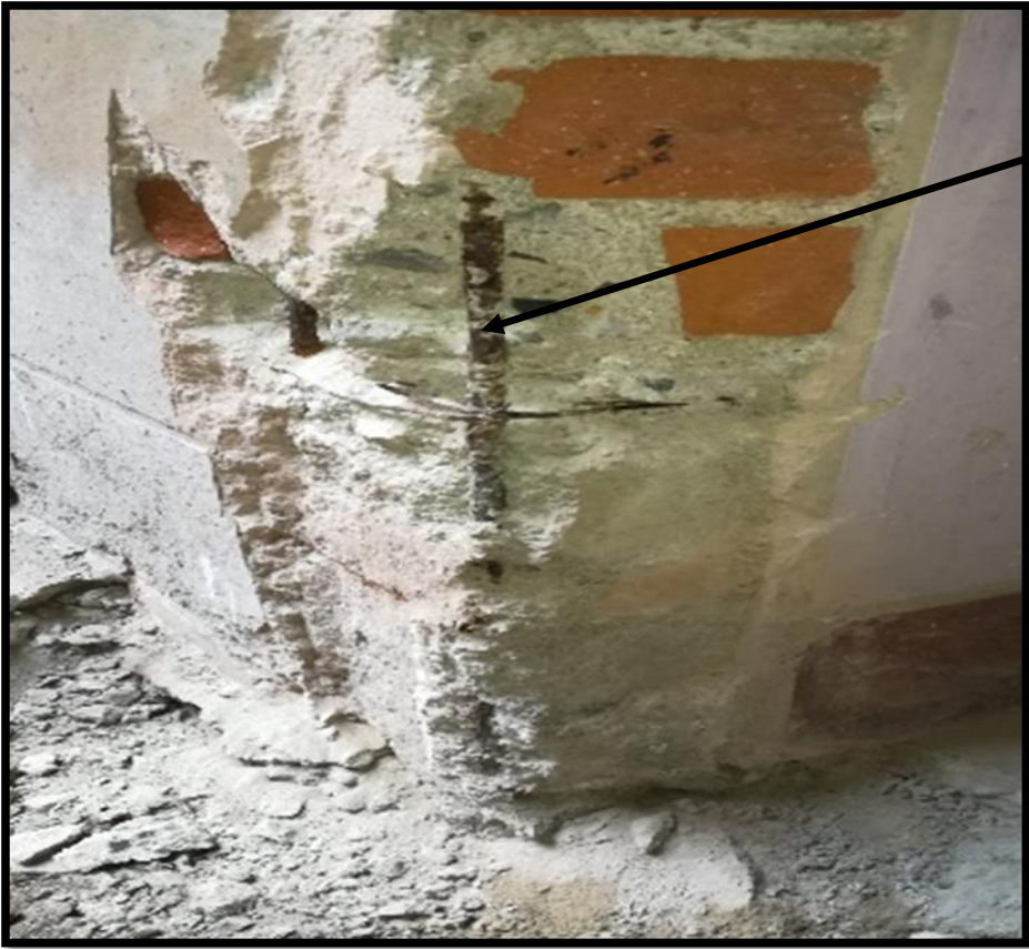
Corrosión en el acero de refuerzo y estribos
