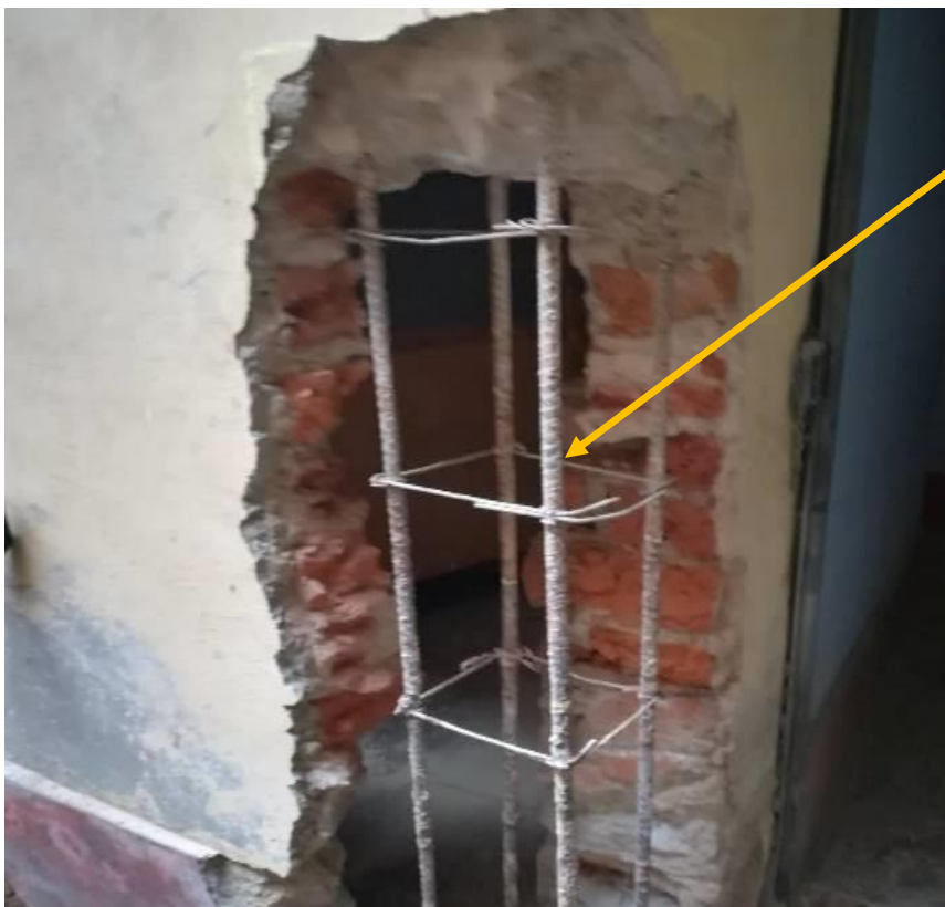
Se observa corrosión en Acero de \frac{1}{2} " y estribos de \frac{1}{4} " -
