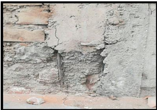
Anexo 13: acero expuesto a la intemperie.
