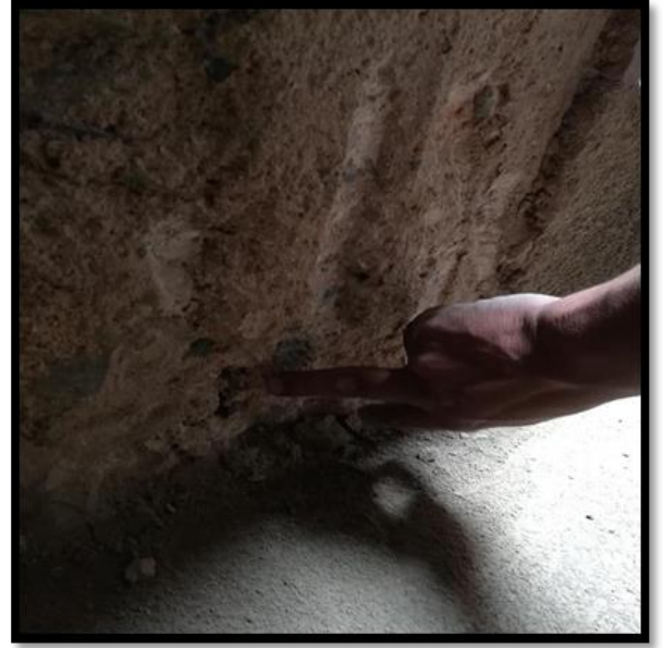
Anexo 22: corrosión grave de acero.
