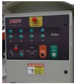
Figura N° 7: Tablero de control
