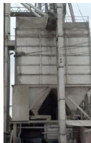
Figura N° 11: Tolvas de alimento molido
