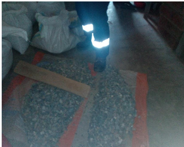
Fotografía 125. Cuarteo de la piedra chancada
