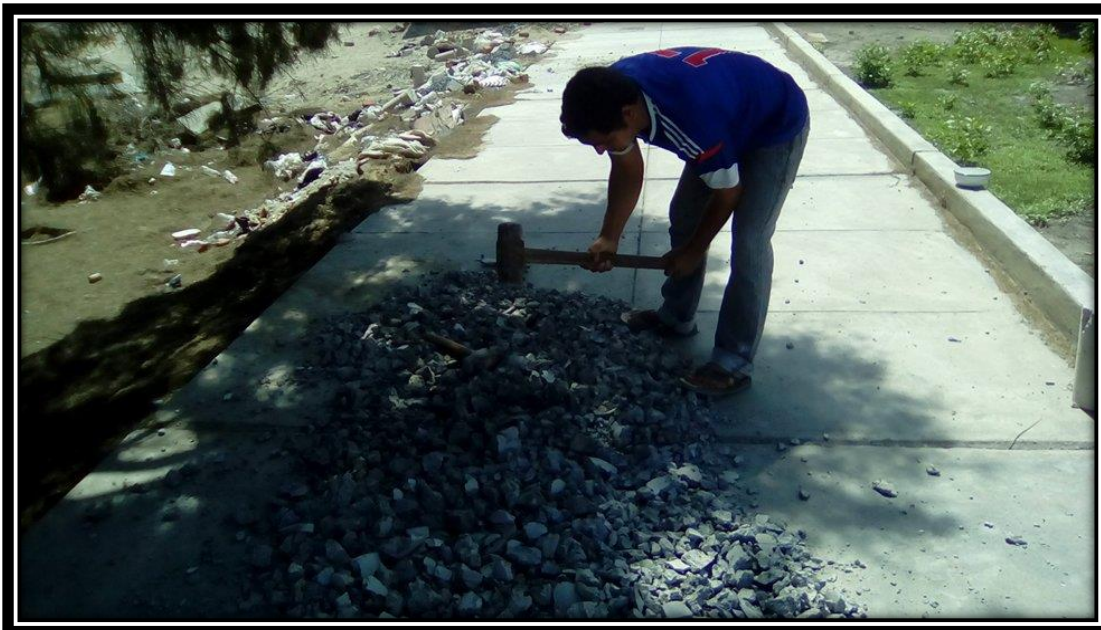
FOTO N° 02: Los residuos de concreto que se recolectaron, en proceso del chancado o trituración manualmente con una comba hasta alcanzar el tamaño máximo del agregado grueso.
