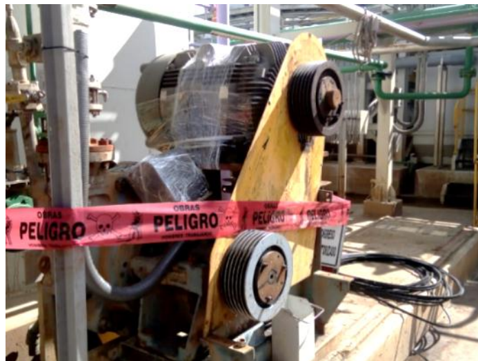
Imagen 14 Motor de planta AWTP
