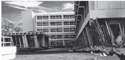
Hospital Olive View NO UTILIZÓ AISLADORES
