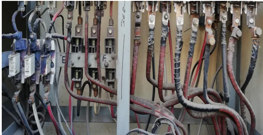
FIGURA 21 Calibres de conductores en tablero
