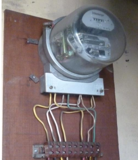
FIGURA 22 Medidor trifásico electromecánico de servicio particular.
