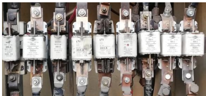
FIGURA 19 Fusibles de baja tensión tipo NH en HI0032
