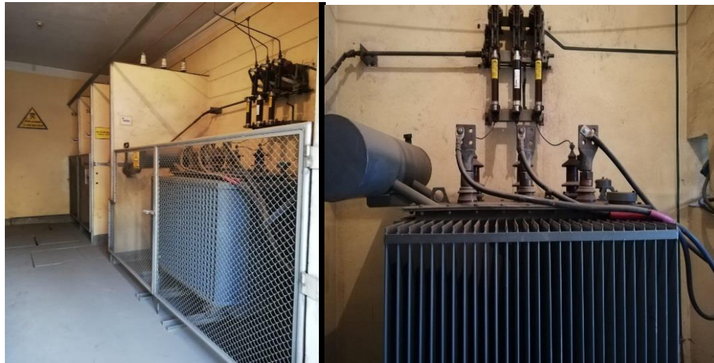
FIGURA 20 Transformador de distribución.
