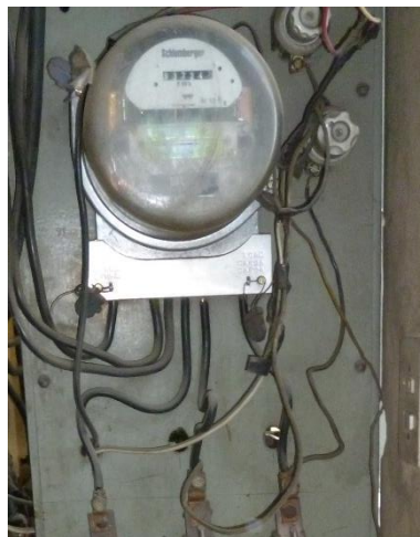
FIGURA 23 Medidor trifásico electromecánico de alumbrado público.
