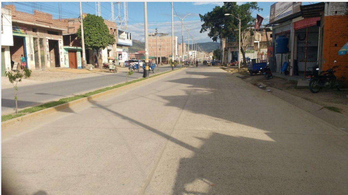
Imagen 2 : estado actual del pavimento
