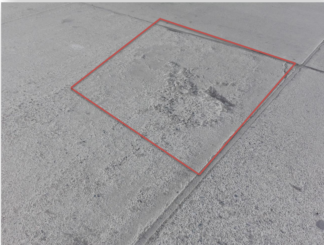
Imagen 6 : Fisura Descascaramiento y Fisuras Capilares Fuente: Visita de Campo
