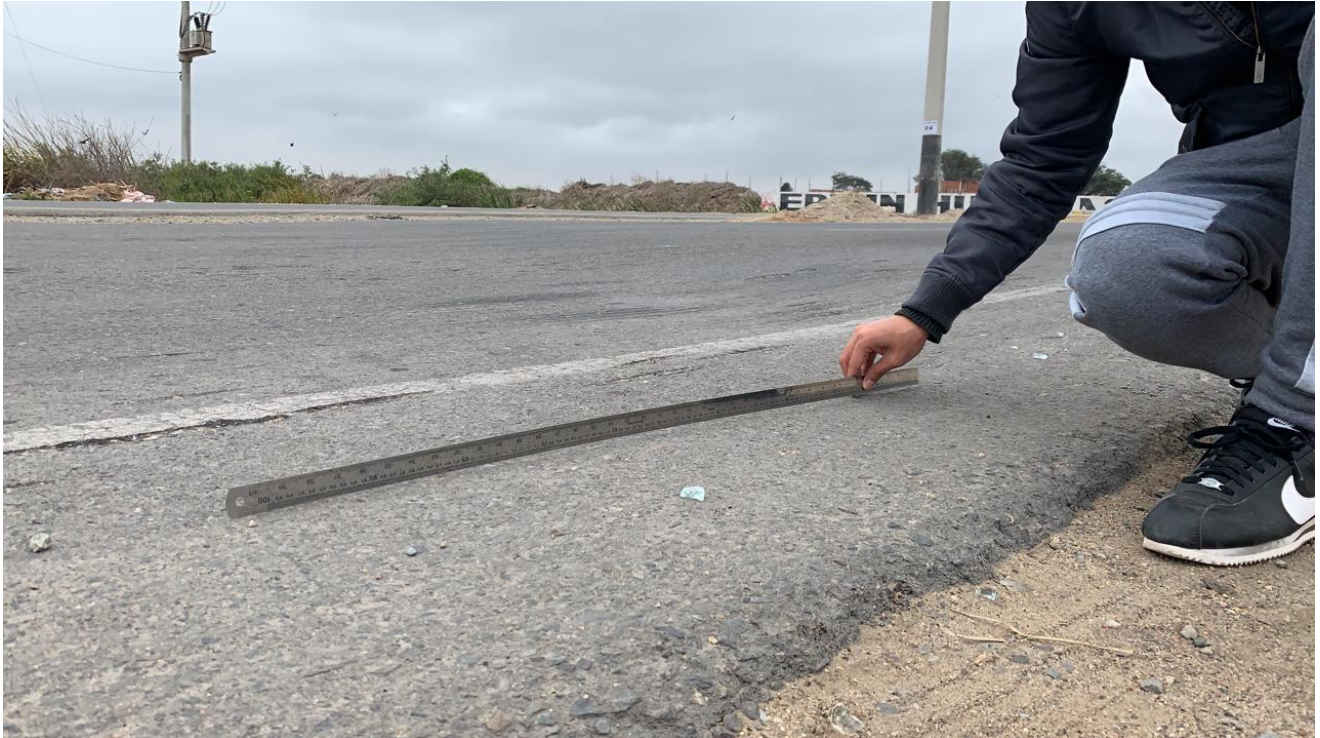
Figura 19. Medición de falla por ahuellamiento
