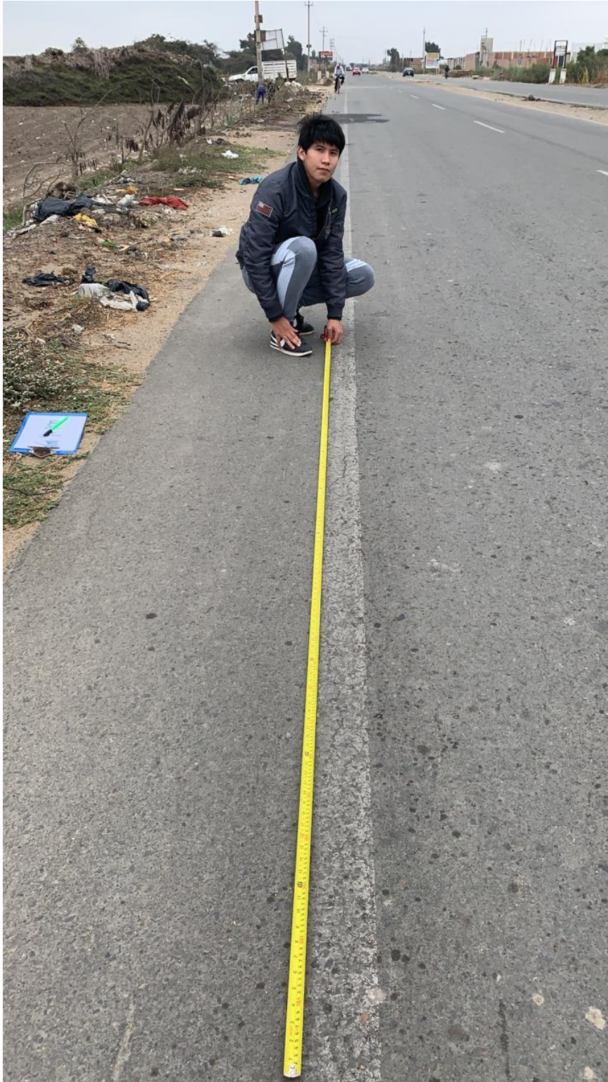
Figura 11. Medición de falla grieta de borde
