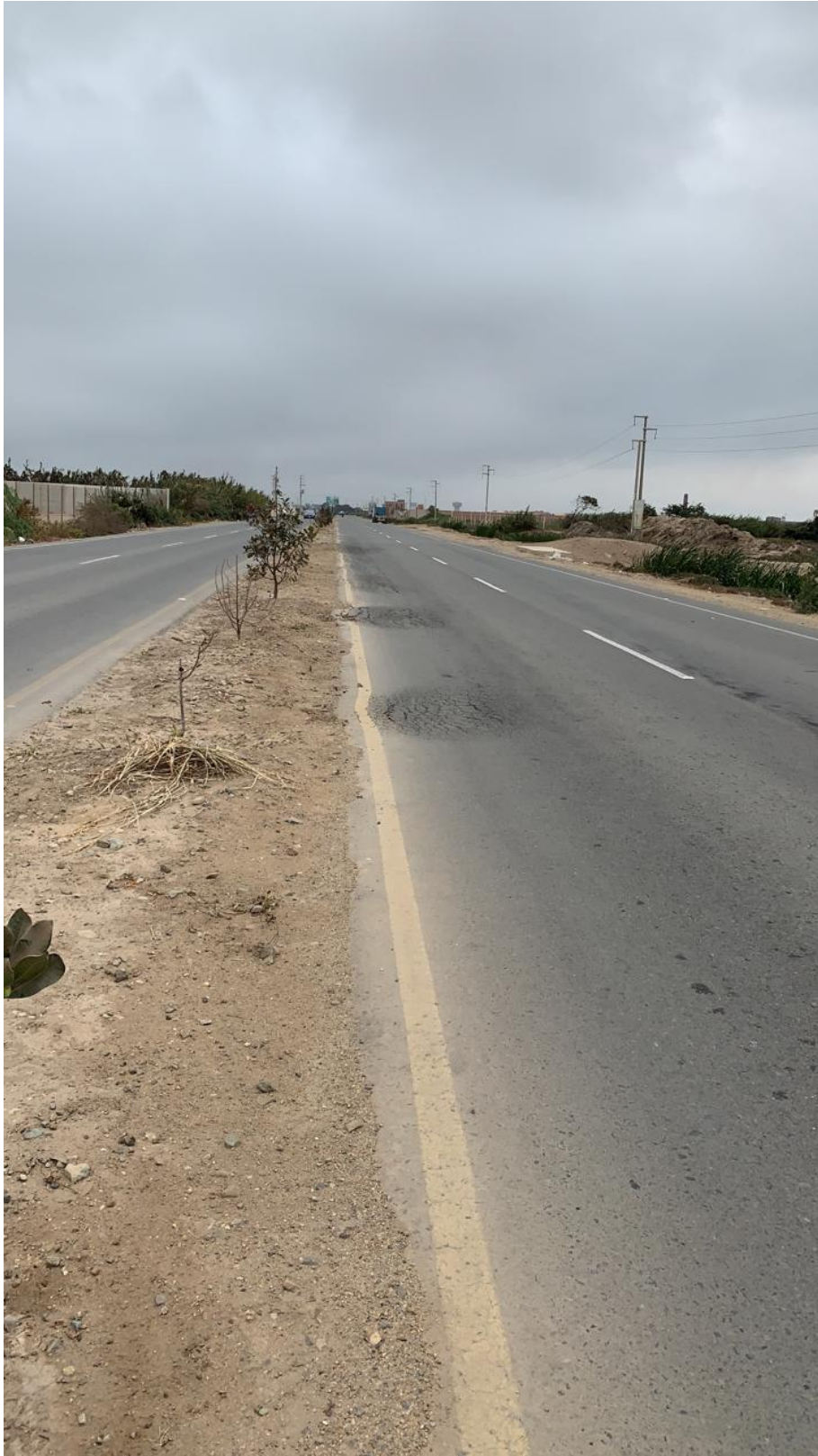
Figura 25. Múltiples fallas piel de cocodrilo
