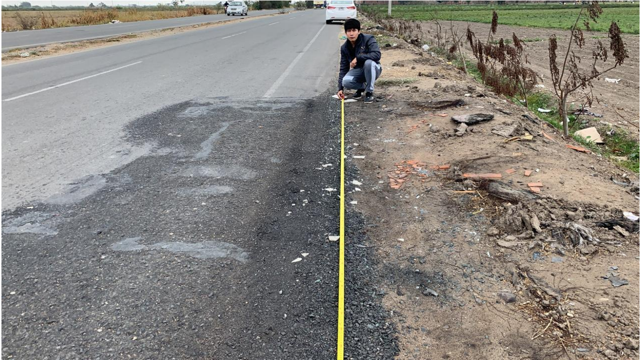
Figura 10. Medición de falla desprendimiento de agregados
