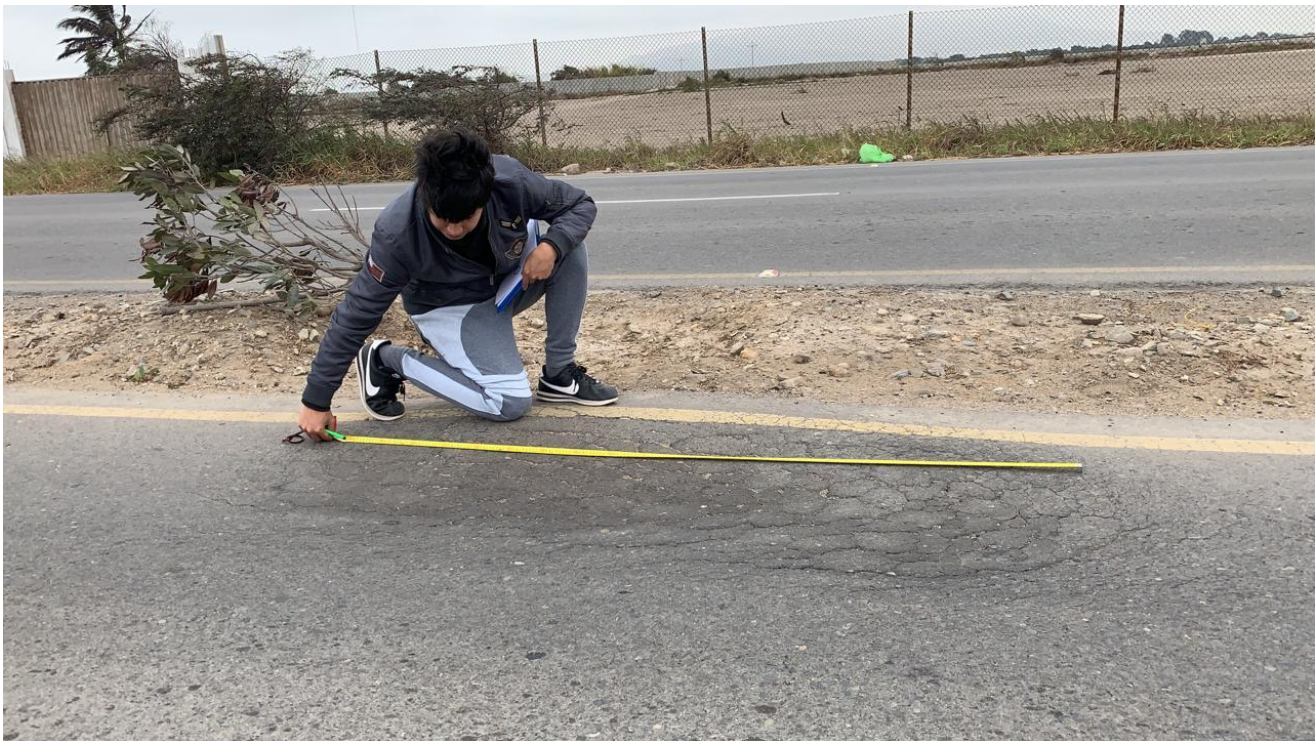
Figura 24. Medición de falla piel de cocodrilo
