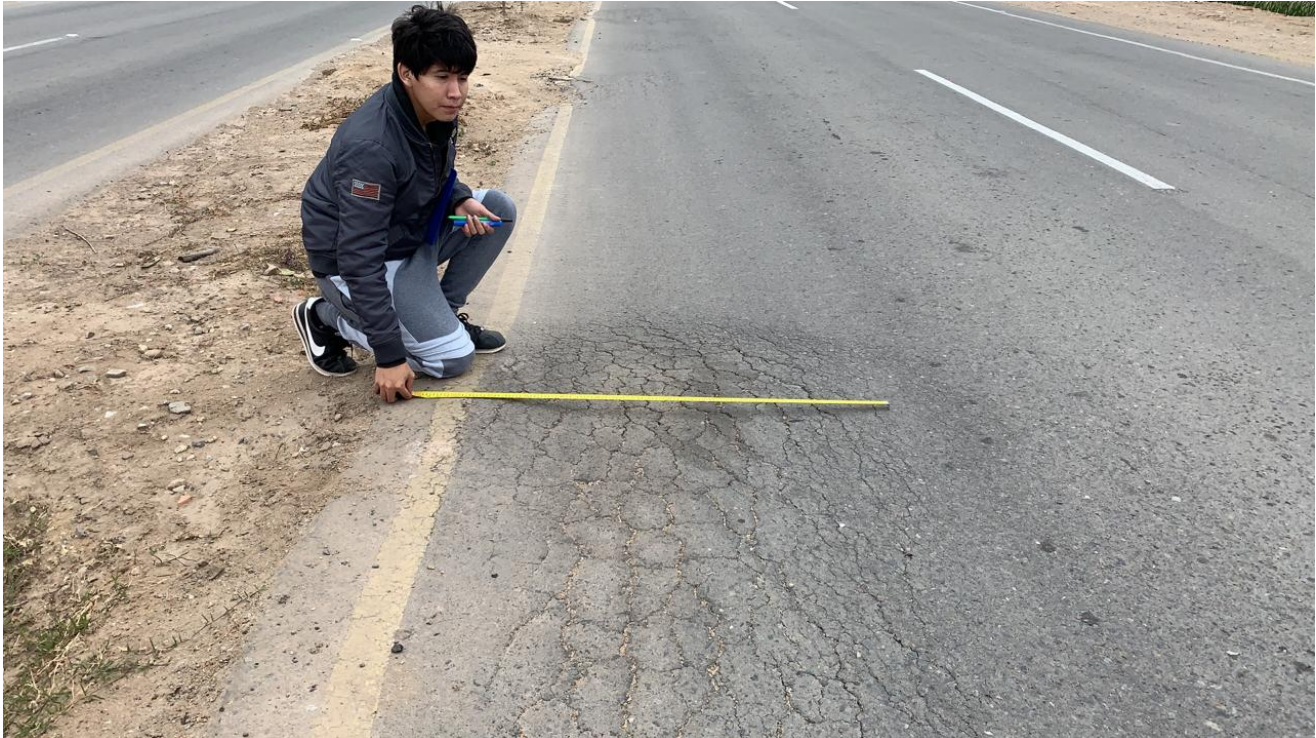
Figura 33. Medición de falla piel de cocodrilo
