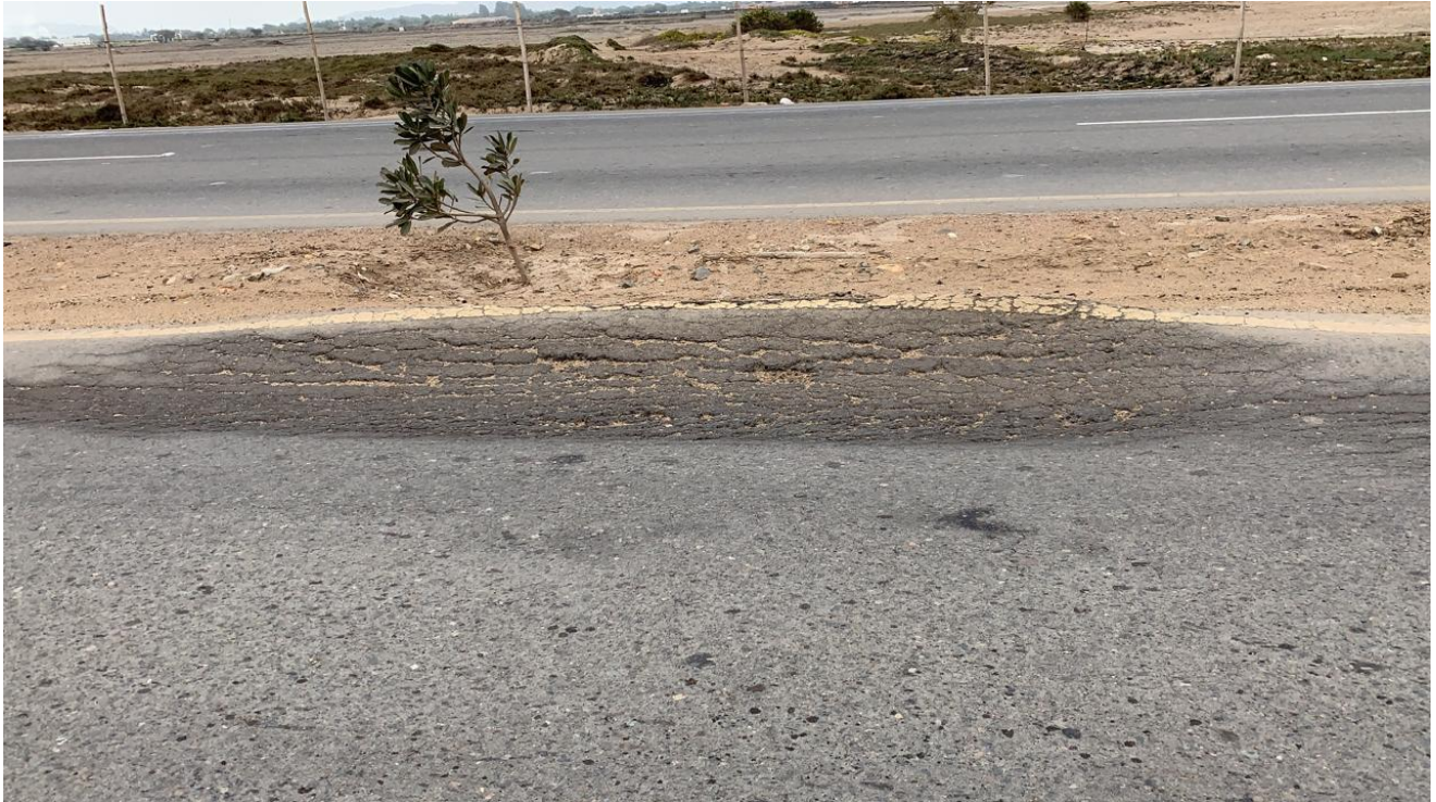
Figura 39. Falla de desplazamiento y ahuellamiento
