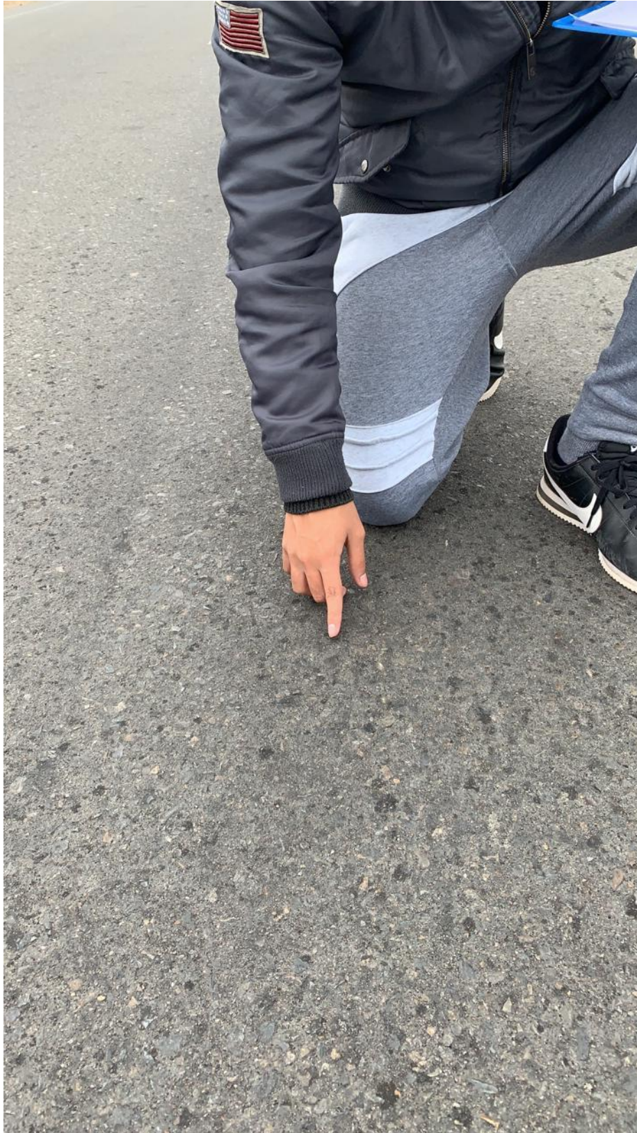
Figura 16. Falla pulimiento de agregados
