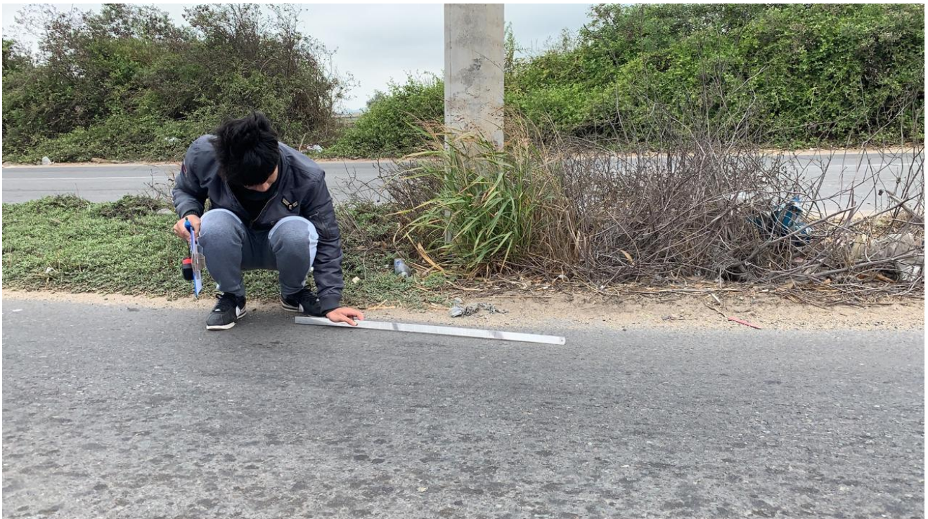
Figura 22. Medición de falla por ahuellamiento
