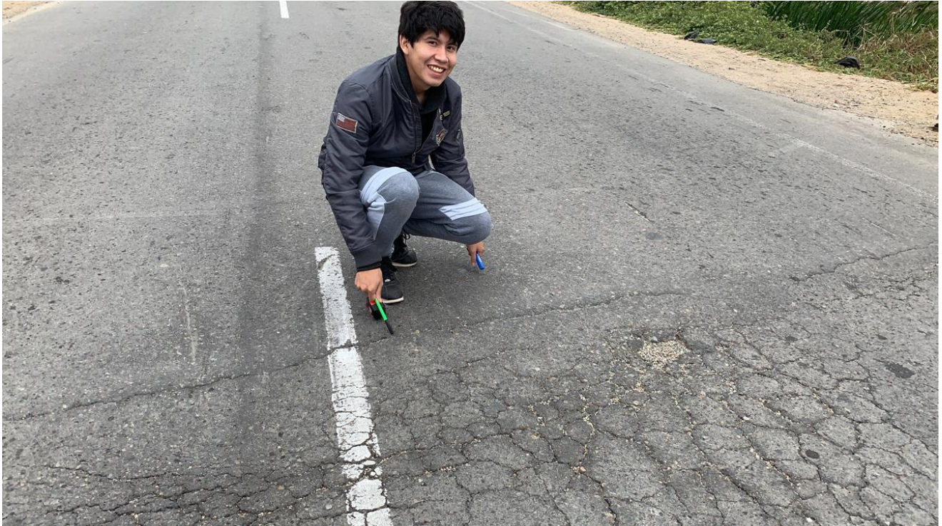
Figura 43. Falla grieta transversal total
