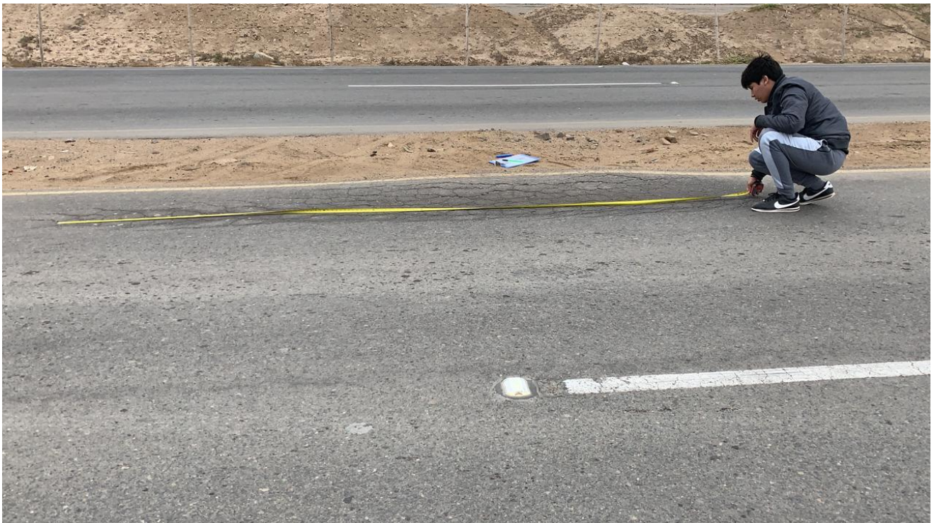
Figura 36. Medición de falla piel de cocodrilo
