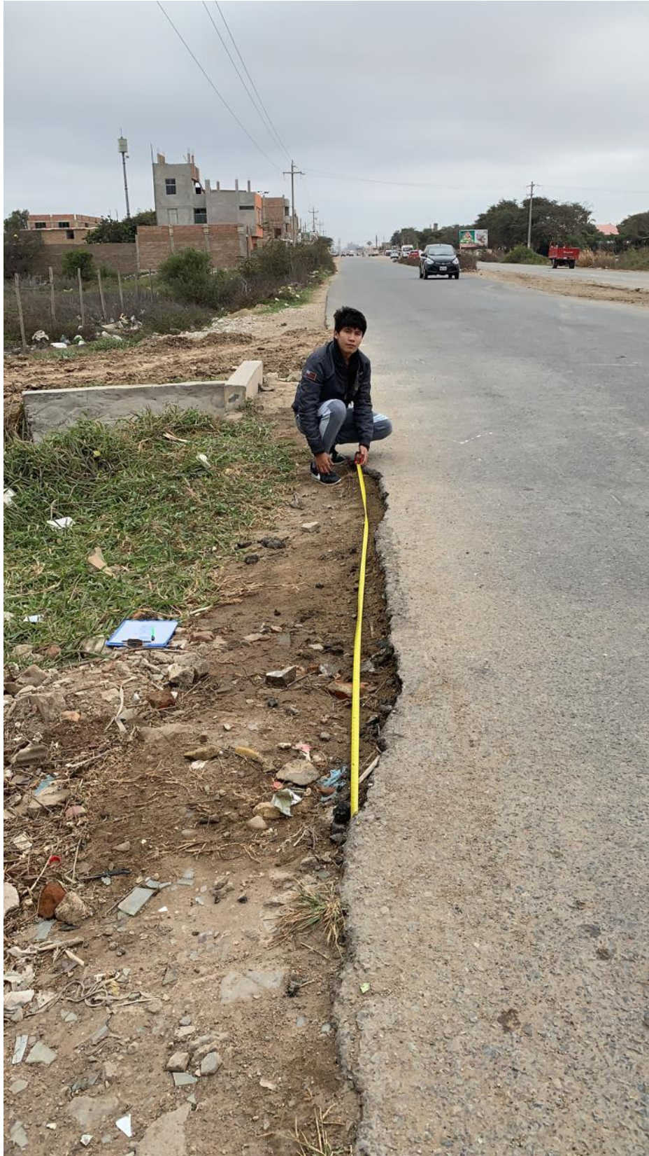
Figura 8. Grieta de borde
