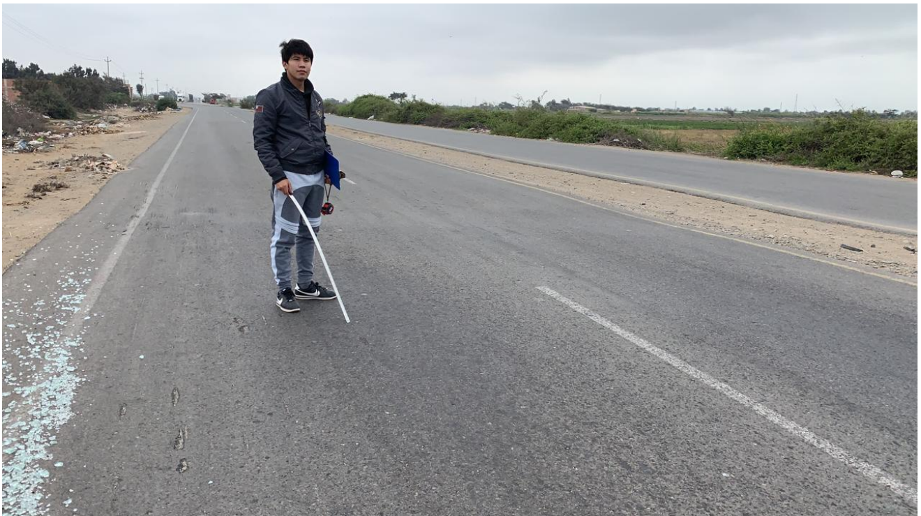
Figura 20. Falla por pulimiento de agregados
