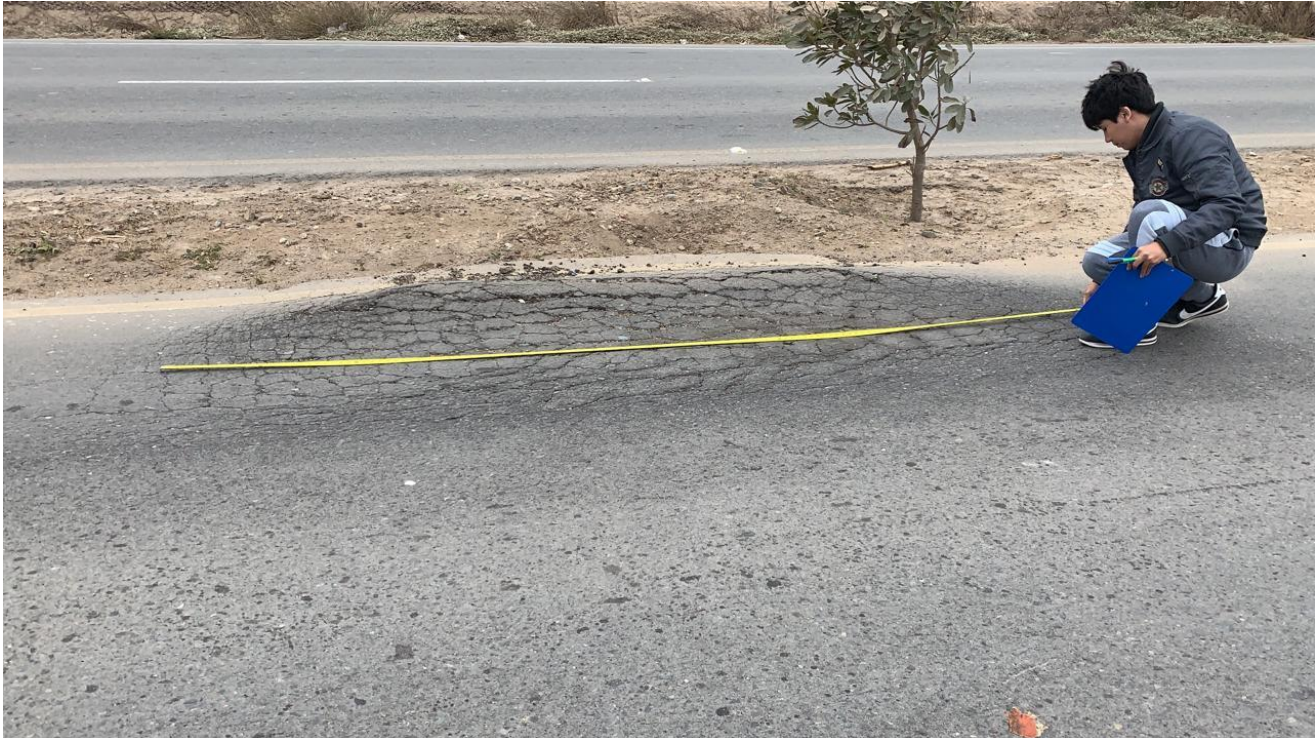
Figura 29. Medición de falla piel de cocodrilo
