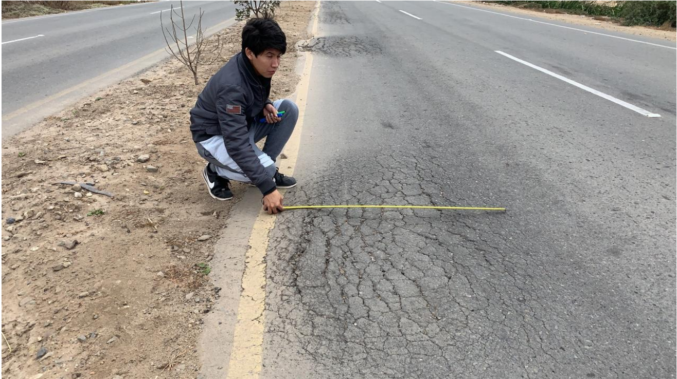
Figura 27. Medición de falla piel de cocodrilo
