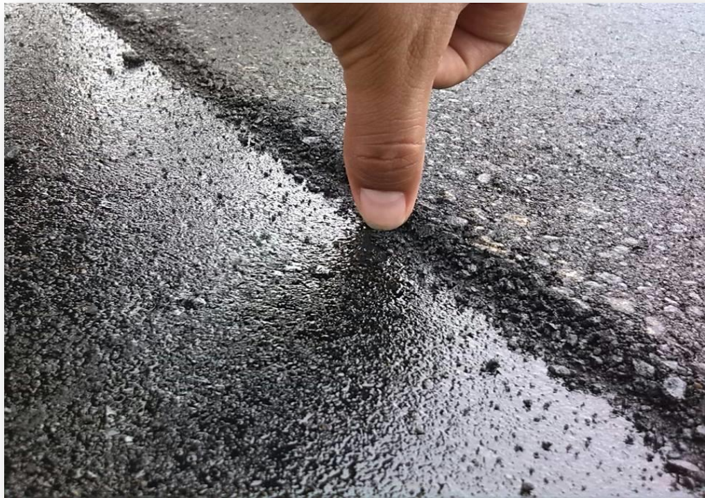
Ilustración 20. Reducción de espesor de mezcla asfáltica
