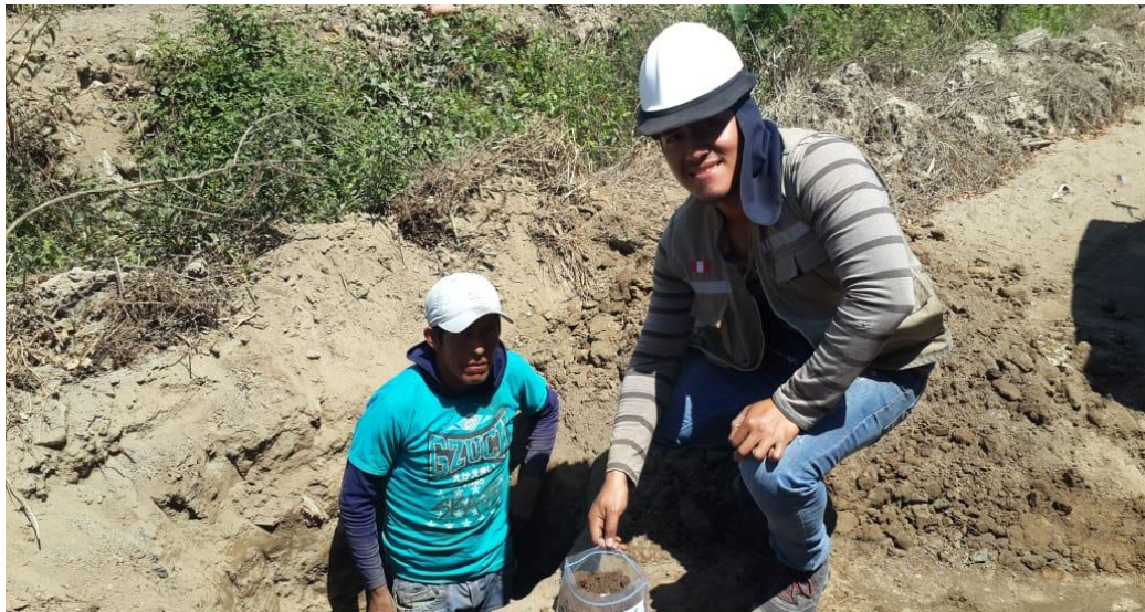
Extracción de materiales para el posterior estudio de mecánica de suelos km - 07
