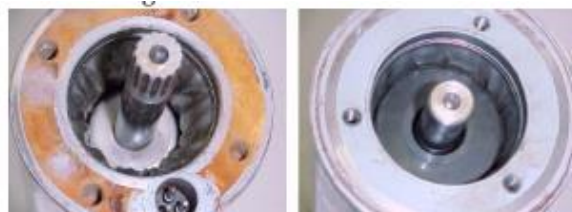
Ilustración 10. Falta de refrigeración
