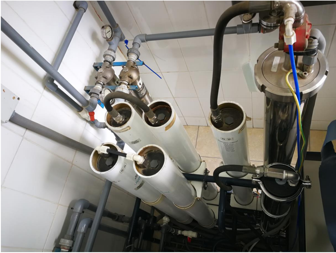
Figura 3. Segundo sistema de osmosis inversa después del rediseño.
