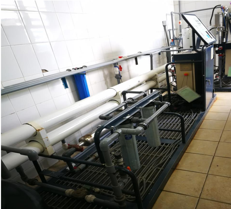
Figura 1. Primer sistema de osmosis inversa.
