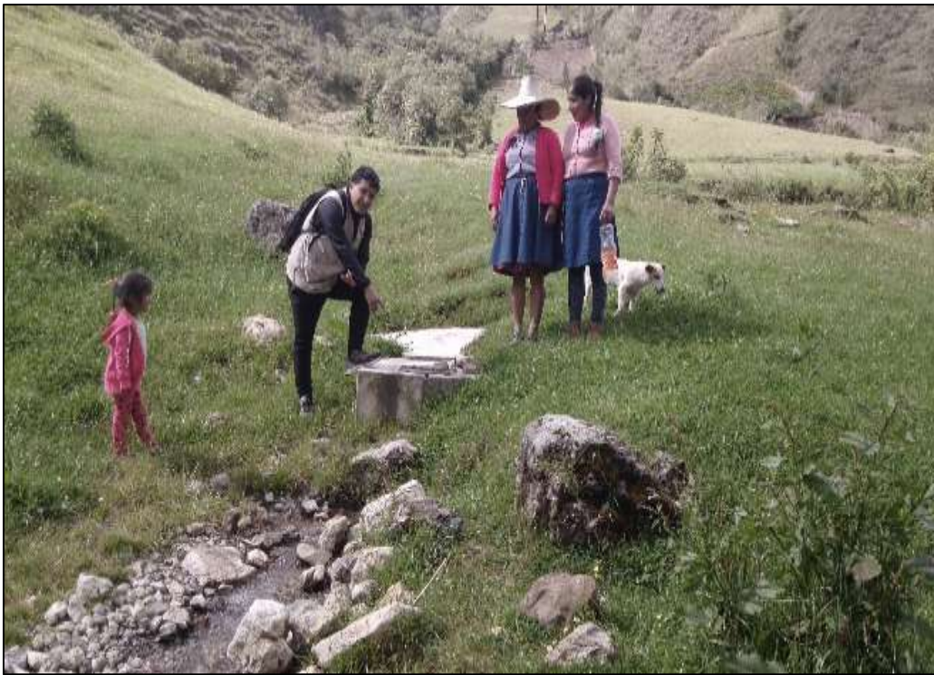
Panel N° 03: Verificando el estado de conservación de los Sistemas de Agua Potable del caserío; donde la Captación fue construida como una caja de almacenamiento de agua, y las cámaras rompe Presión no fueron diseñadas con los criterios normativos de diseño correspondientes, verificado in situ en presencia de las Autoridades de la JASS Mullate y usuarios.
