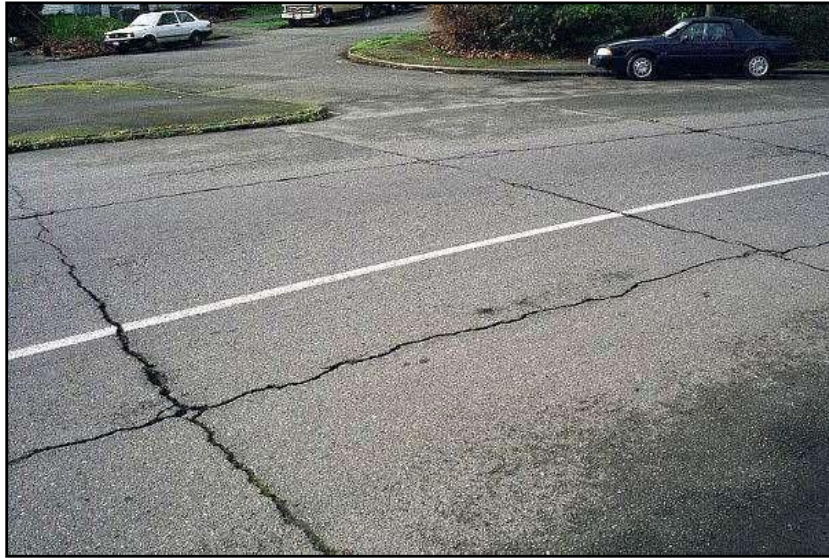
Figura 11 Fisura de Reflexión de Junta
