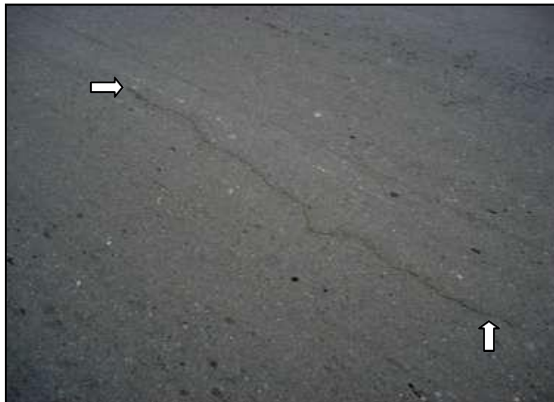
Figura 13 Fisuras Longitudinales y Transversales
