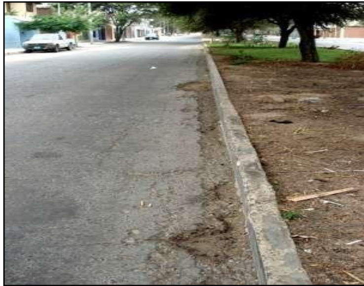
Figura 10 Fisuras de Borde
