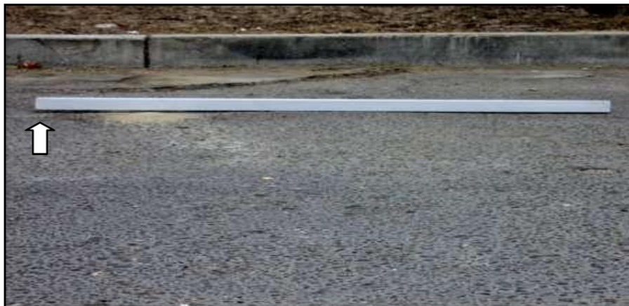
Figura 7 : Abultamientos y Hundimientos
