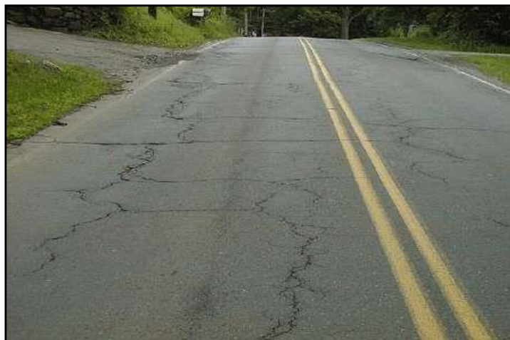
Figura 6 Fisuras en Bloque
