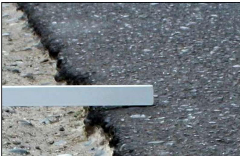
Figura 12 Desnivel Carril - Berma
