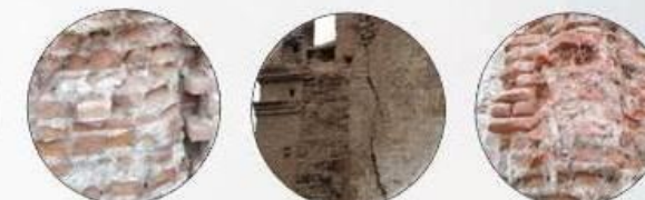
Desprendimiento Erosión Lesión Biológica
