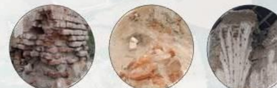
Desprendimiento Eflorescencia Erosión
