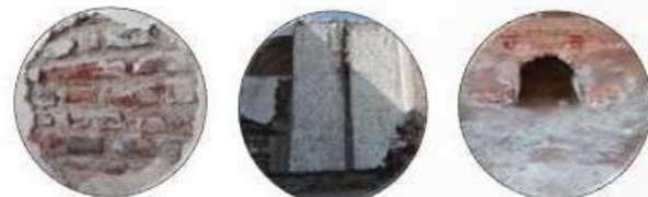
Desprendimiento Erosión Eflorescencia
