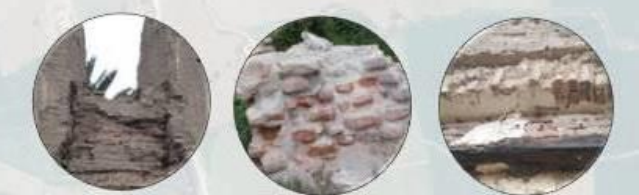
Desprendimiento Erosión Lesión Biológica
