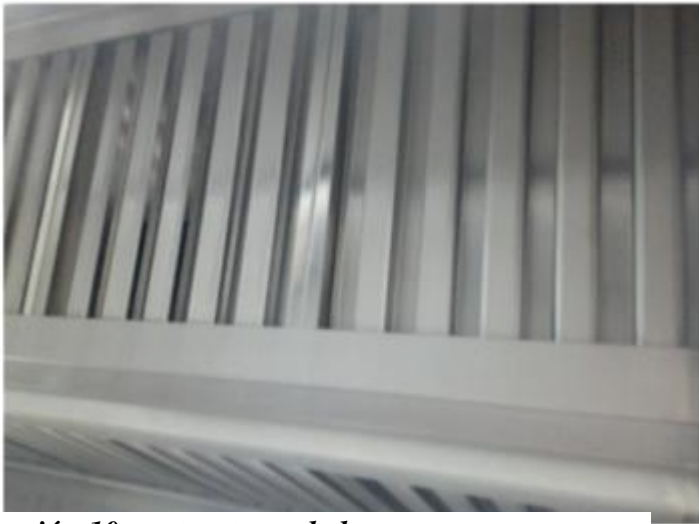
Ilustración 10 - extractores de humo
