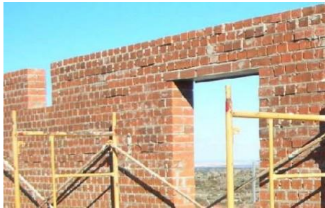
Figura 4 Albañilería sin confinamiento de concreto armado
