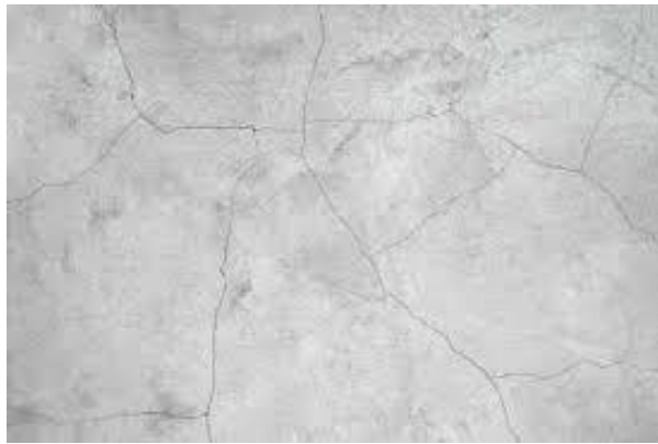
Figura 3:Fisuras en Muros de Contención
