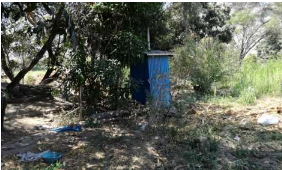
Figura 19. En la vista fotográfica se observa las letrinas, de diferentes partes del en el sector Pósope Bajo del distrito de Pátapo que se encuentra en estado deplorable.
