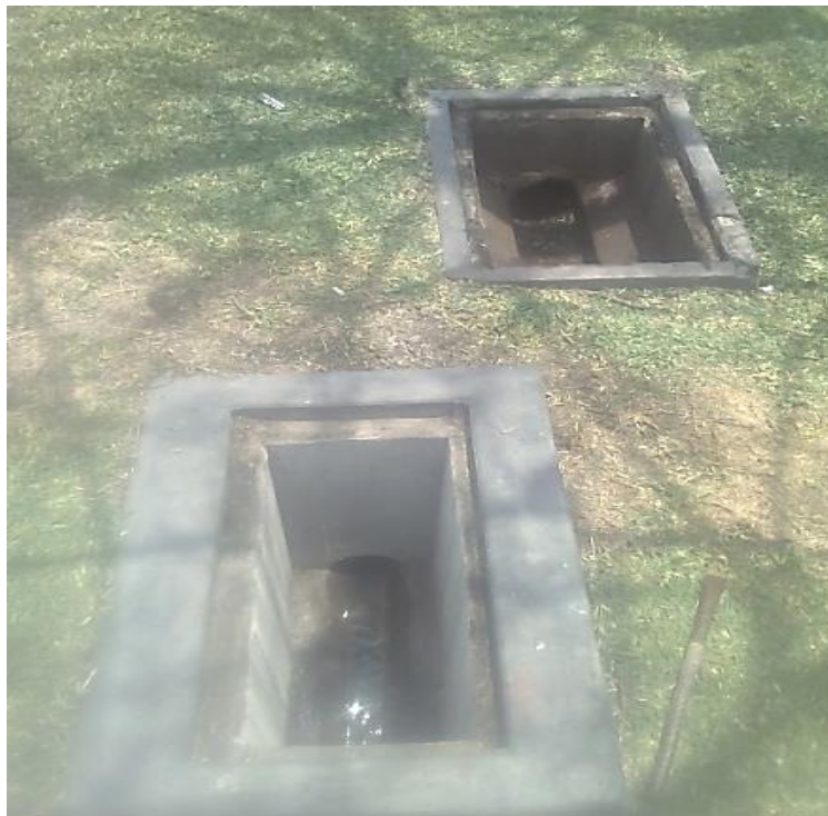
Figura 15: Cámara de inspección en la parte izquierda la nueva y la parte derecha la antigua caja de registro que están en paralelo.
