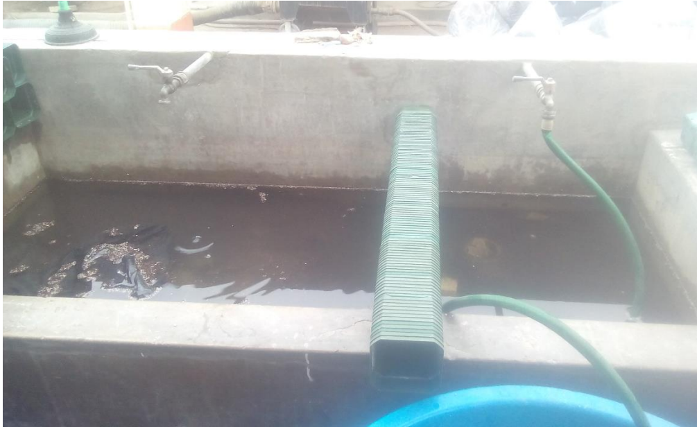
Figura 12: lavadero atorado no drena con facilidad debido a la tierra.
