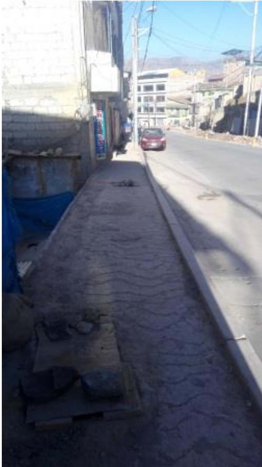
Figura 17. Veredas construidas y veredas cubiertas El muro contiguo ha sido derribado ha dado paso una vereda angosta y de calidad para los transeúntes si bien todavía necesita su cubierta.
