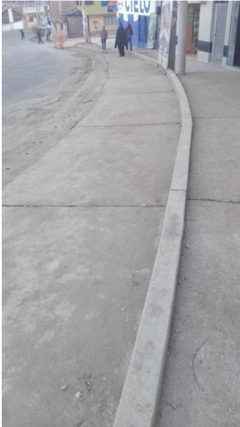
Figura 23. De fuente propia, se muestra el estado actual del paradero Uchullo Grande. La anterior canaleta que representaba un peligro para los peatones, asimismo, las veredas que no estaban aún uniformes y con visibles desgastes por el uso, ahora lucen nuevas.
