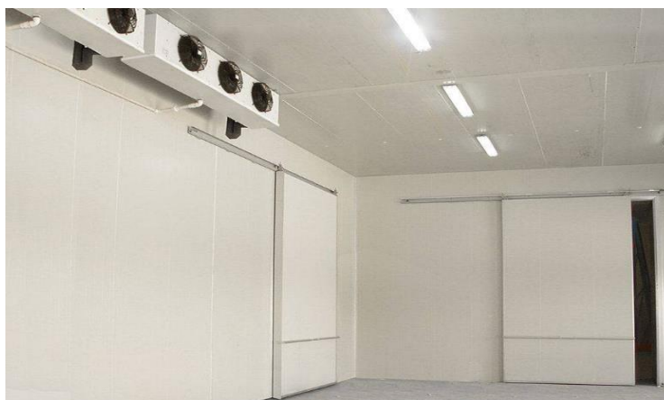
Figura 15: Cámara frigorífica. Sala para caminar, 2018. Recuperado de https://cumarefrigeration.com/walk-in-cold-room-projects/
