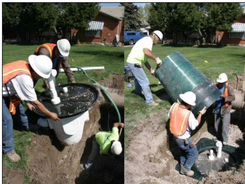
Imagen N°2 instalación de cámara de vacío. Fuente: Ministerio de Vivienda, Construcción y Saneamiento.
