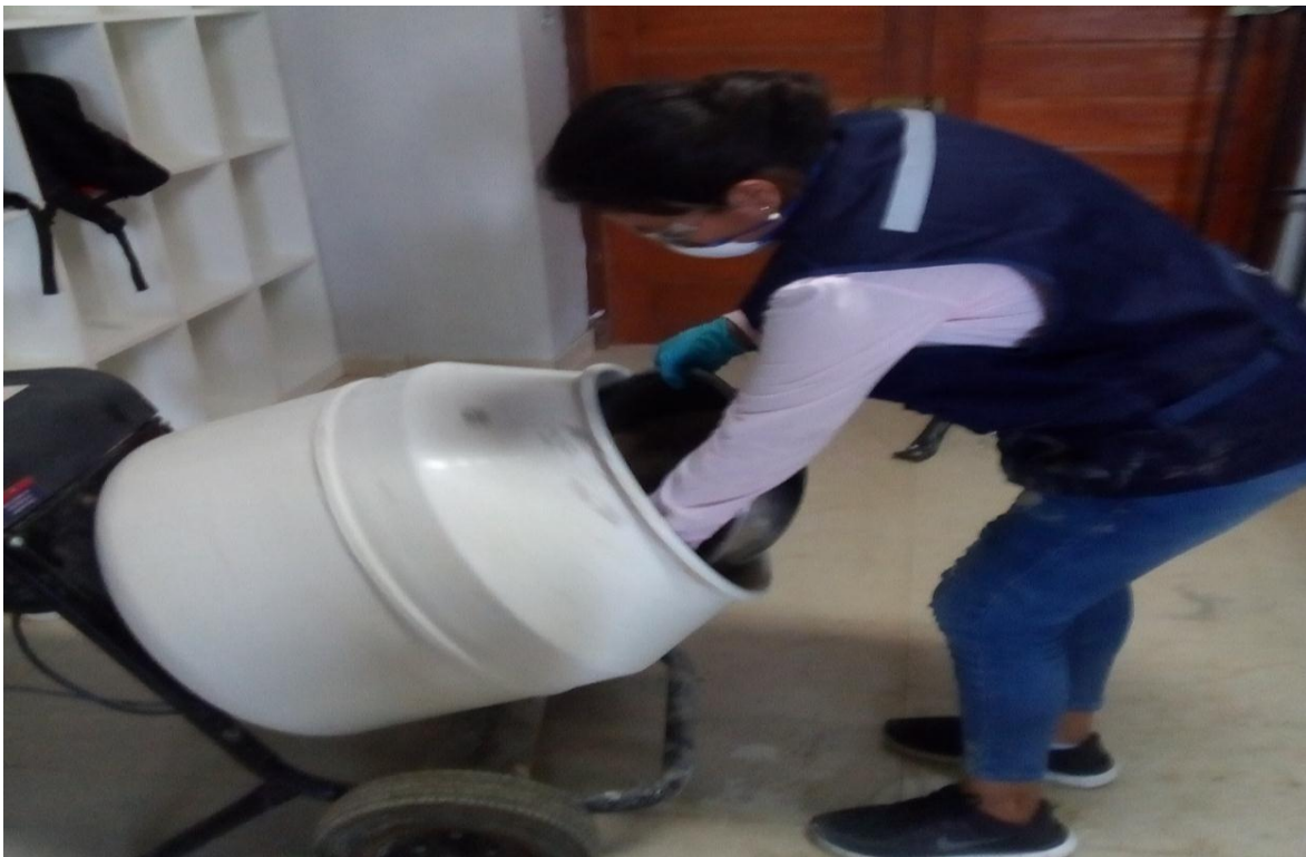
Fotografía: Preparación de mezcla para elaboración de bloques de concreto, utilizando caucho de neumático, agregado grueso y agregado fino.
