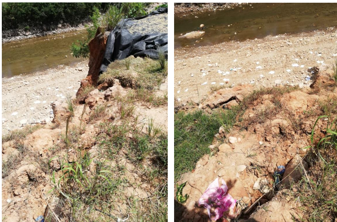
FOTO 07: Estado en el que se encuentra la ribera del sector a causa de los constantes deslizamientos en la zona por las inundaciones.
