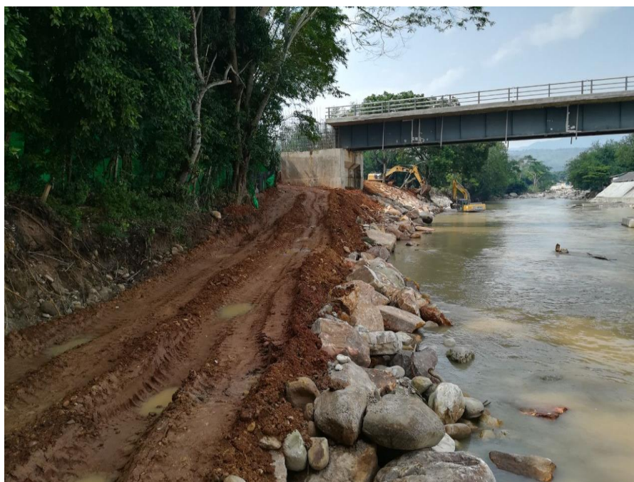
FOTO 08: En la imagen se muestra el cauce de la quebrada que desemboca en el río cumbaza, que gradualmente se erosiona debido a que se usa como botadero de basura. Además de ser el suelo poco compacto.
