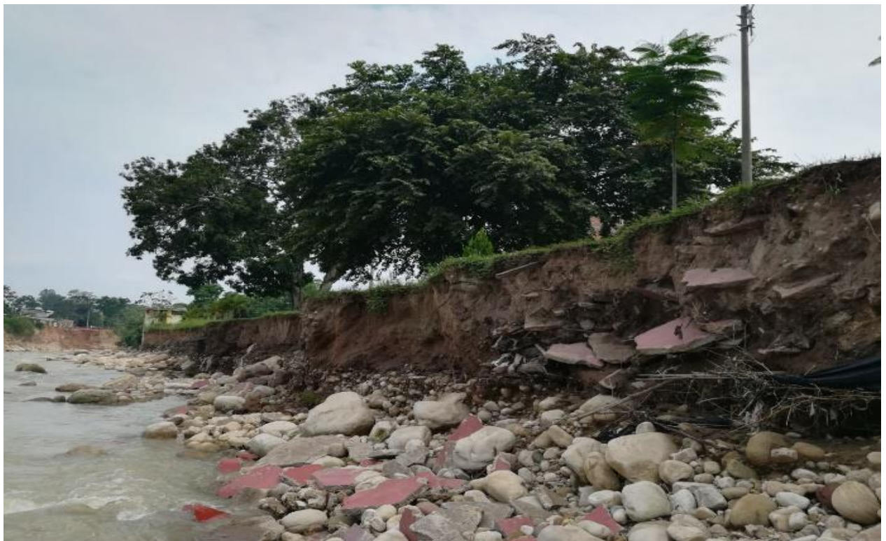
FOTO 02: Estado en el que se encuentra el borde del Río.
